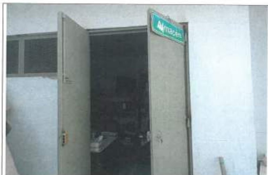
Foto N° 8: Se evidencia la instalación de la señalética informativa en el ambiente de almacén.
