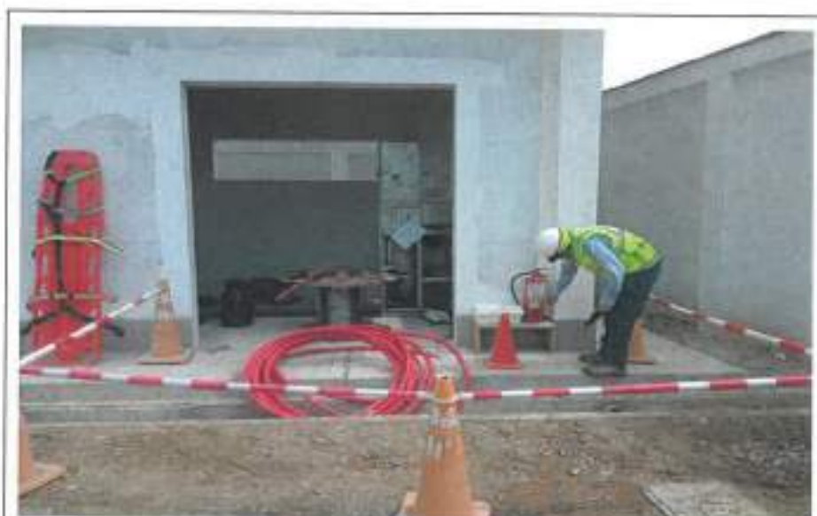
Foto N° 17: Se evidencia la inspección del extintor en la Sub estación del grupo electrógeno, módulo M.
