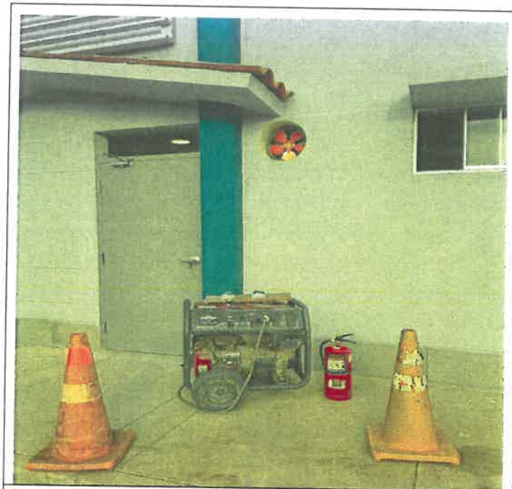
Foto N° 6: Se evidencia la inspección del extintor, ubicado en el generador.
