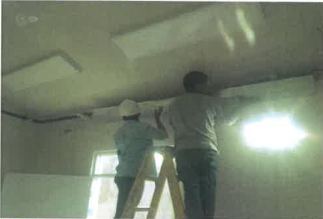
FOTOGRAFÍA 03: INSTALACION DE BANDEJAS DE SOPORTE DE TUBERÍAS DE COBRE REGRIFERATIVO PARA EL MÓDULO "K" EN LA SEDE DE VIGILANCIA Y MÓDULO "F" SEGUNDO Y TERCER PISO, EN ZONA DE TRATAMIENTO.
