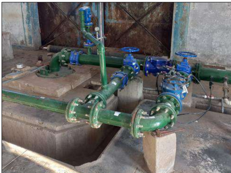
Imagen N° 79: Vista interna del pozo N° 1-Localidad San José
