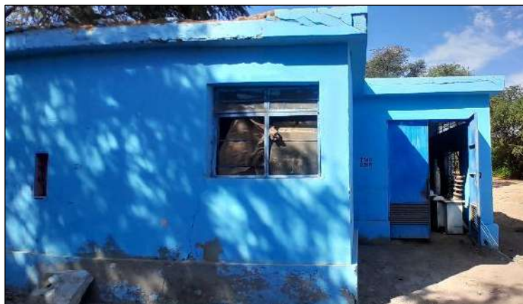
Imagen N° 108: Vista externa del pozo Mocupe Nuevo – Mocupe
