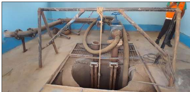
Imagen N° 128: Vista interna EBAR 01 – Localidad Nueva Arica
