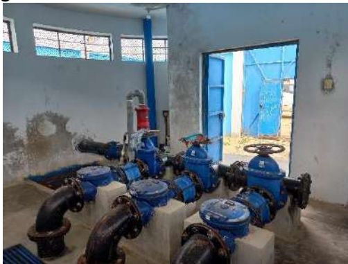
Imagen N° 10: EBAR Fermín Ávila -Localidad Pimentel
