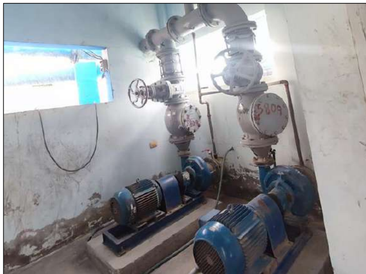
Imagen N° 20: Vista de la Estación de bombeo N° 2-Localidad Lambayeque
