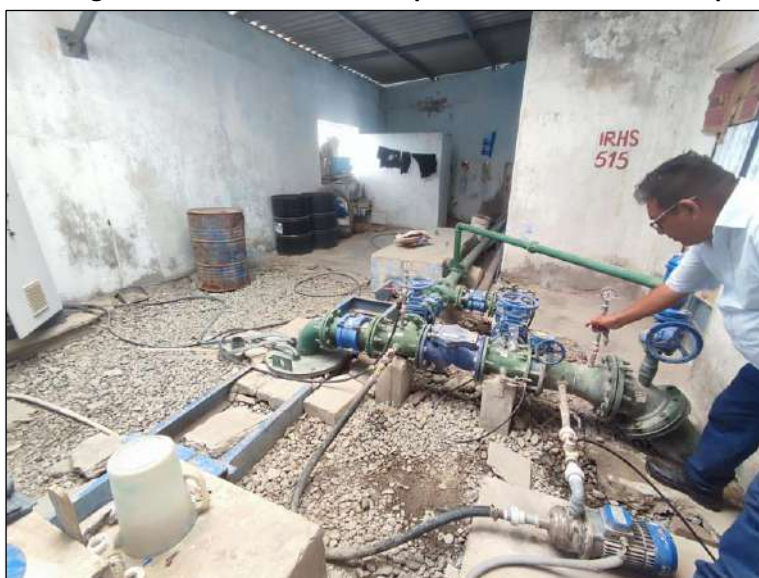
Imagen N° 53: Vista interna del pozo N° 1-Localidad Motupe
