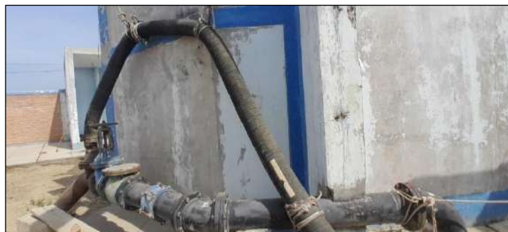
Imagen N° 153: Vista de la EBAR 01 – Localidad Ferreñafe
