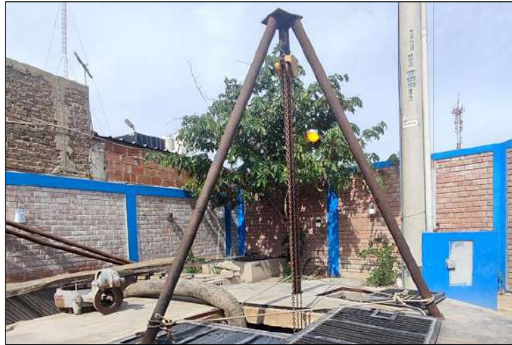
Imagen N° 23: Vista de la EBAR N°02-Localidad Lambayeque
