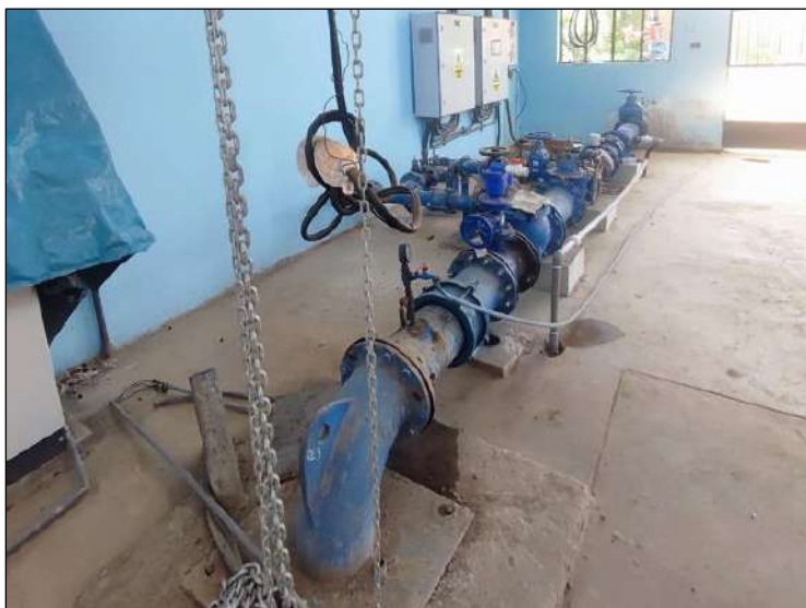
Imagen N° 60: Vista externa del pozo N° 1-Localidad Olmos
