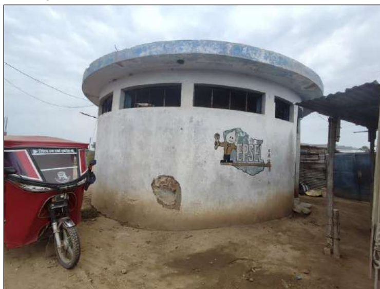
Imagen N° 33: Vista externa de la EBAR N°01-Localidad Íllimo
