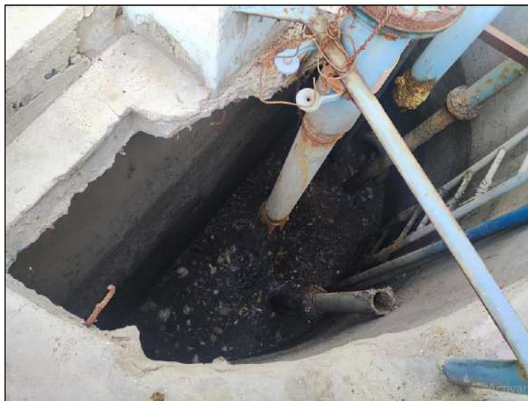
Imagen N° 72: Vista de la cámara húmeda de la EBAR N°01-Localidad Pacora
