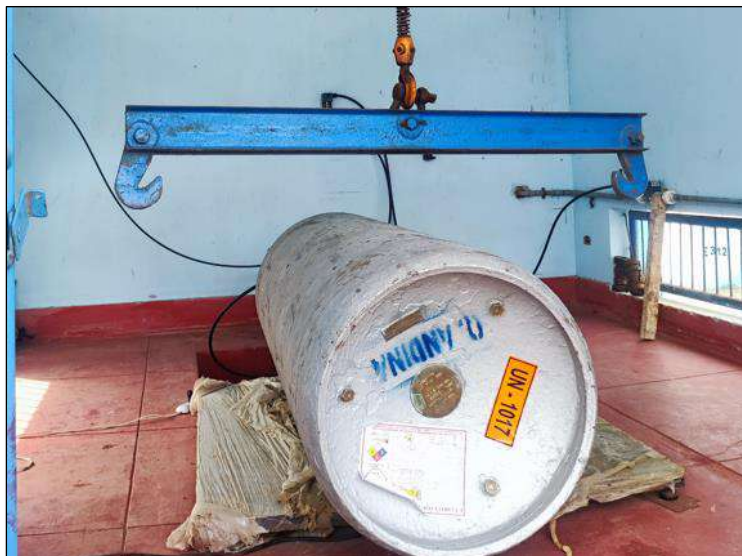
Imagen N° 19: Vista del sistema de Cloración-Localidad Lambayeque
