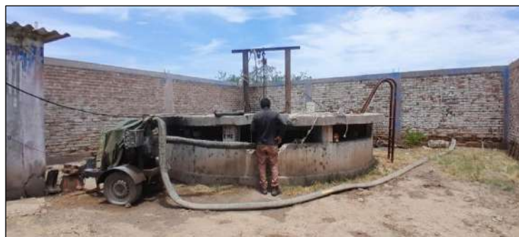
Imagen N° 159: Vista del EBAR 01 – Localidad Picsi
