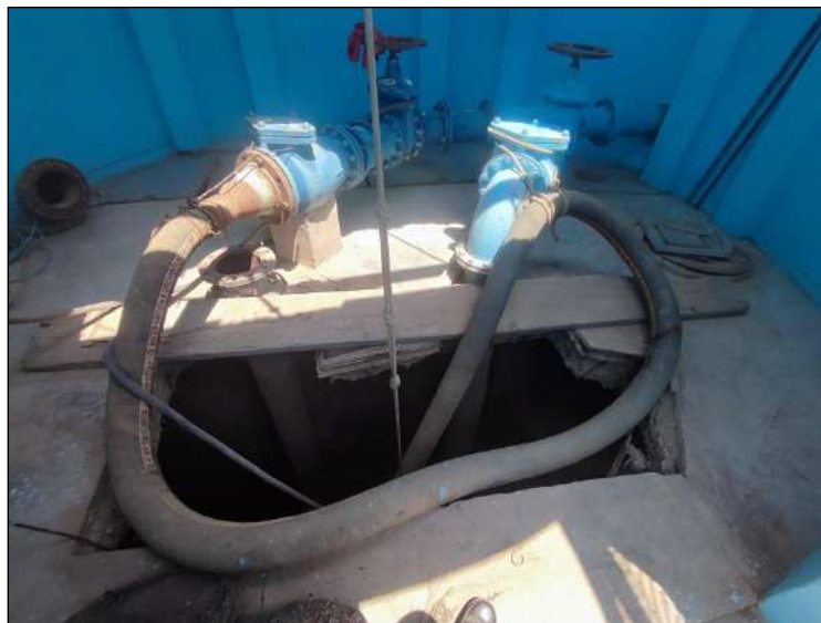
Imagen N° 87: Vista de las válvulas de la EBAR N°01-Localidad Túcume
