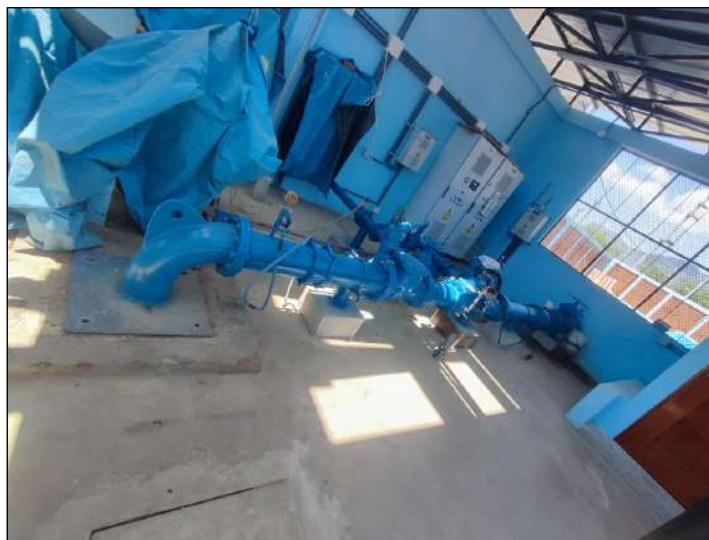
Imagen N° 61: Vista externa del pozo N° 3-Localidad Olmos
