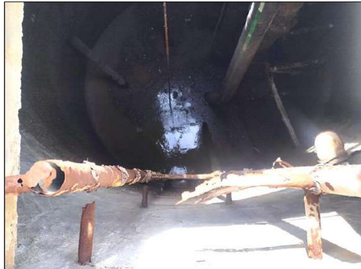
Imagen N° 24: Vista de la cámara húmeda de la EBAR N°02-Localidad Lambayeque
