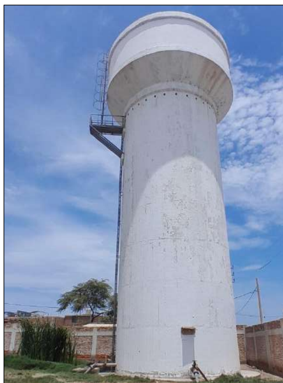
Imagen N° 157: Reservorio R-02 – Localidad Picsi
