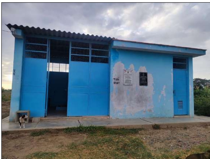
Imagen N° 67: Vista externa del pozo N° 3-Localidad Pacora
