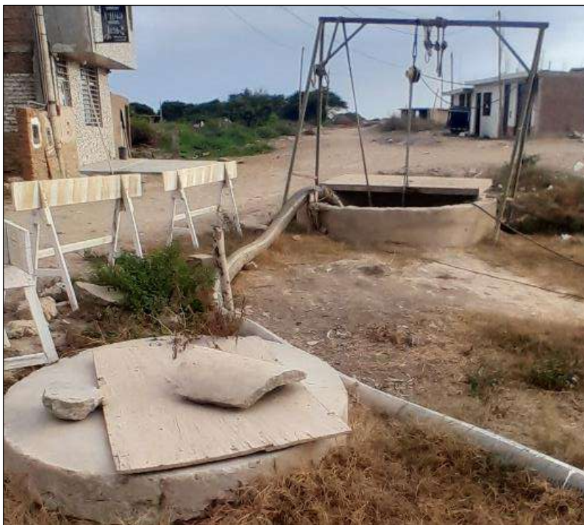
Imagen N° 105: Vista del EBAR 01 – Localidad Monsefú
