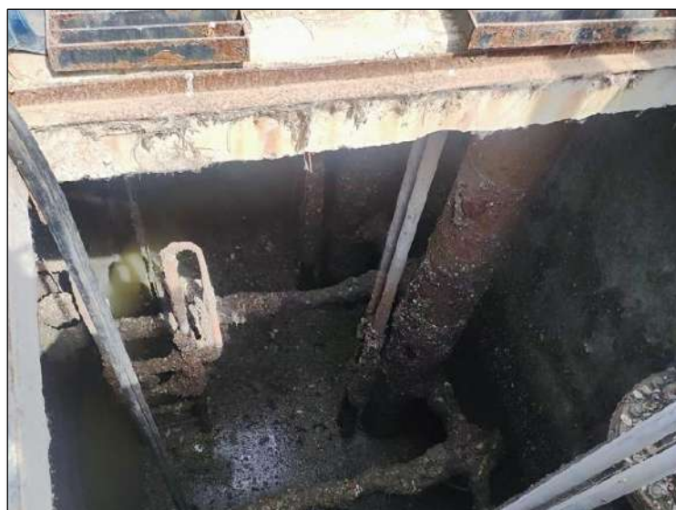
Imagen N° 26: Vista de la cámara húmeda de la EBAR N°05-Localidad Lambayeque
