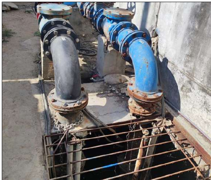
Imagen N° 57: Vista externa de la EBAR N°01-Localidad Motupe
