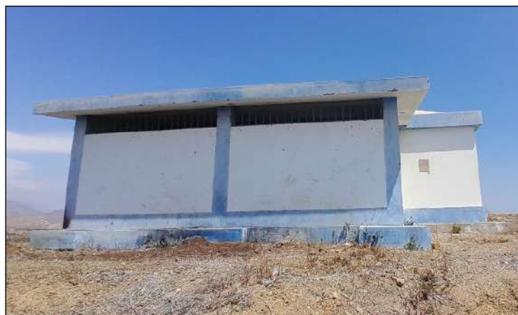
Imagen N° 116: Reservorio 01 y 02 – Zaña
