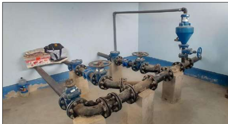
Imagen N° 141: Vista interna del EBAR 01 (Puerto Arturo) – Localidad Reque
