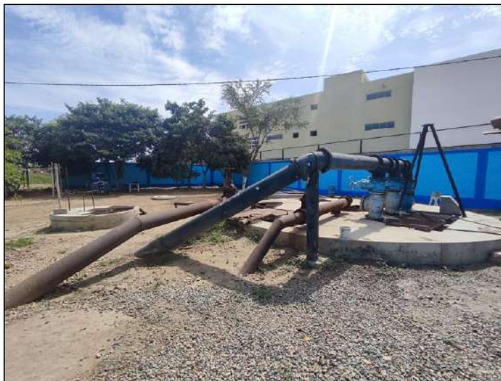
Imagen N° 25: Vista de la EBAR N°05-Localidad Lambayeque
