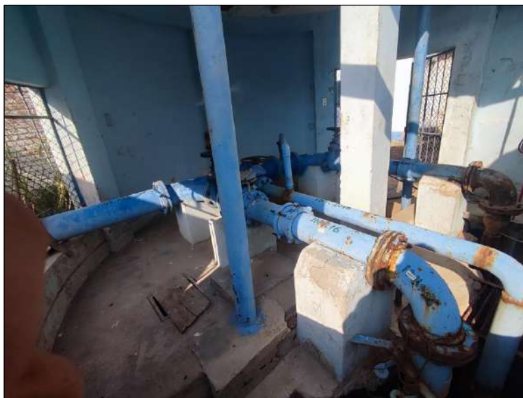
Imagen N° 73: Vista de las válvulas de la EBAR N°01-Localidad Pacora
