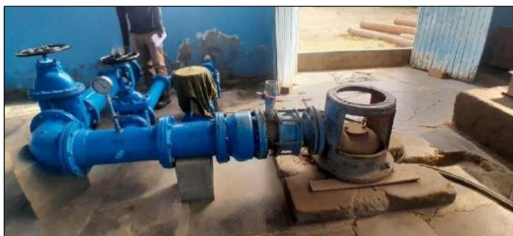
Imagen N° 147: Vista interna Pozo 02 – Localidad Ferreñafe
