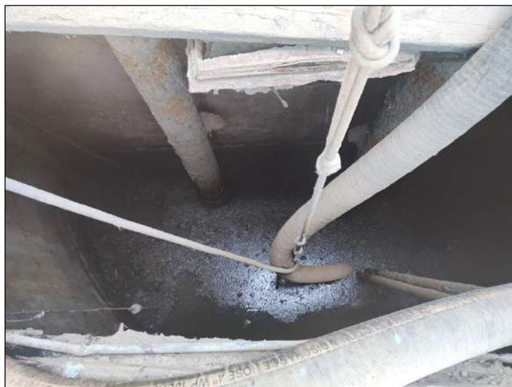
Imagen N° 86: Vista de la cámara húmeda de la EBAR N°01-Localidad Túcume
