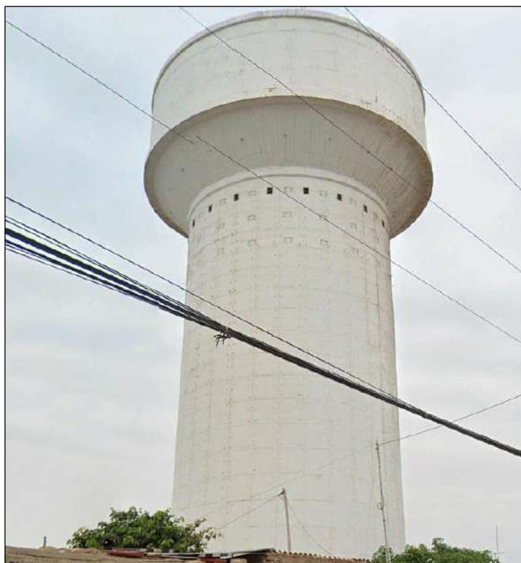
Imagen N° 103: Reservorio R-01 – Localidad Monsefú
