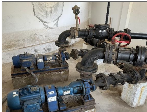
Imagen N° 12: Estación de bombeo Colina Blanca – Cerro Azul
