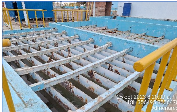
Imagen N° 9: Planta de tratamiento de agua potable N°2 - Imperial
