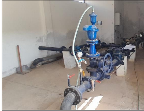
Imagen N° 23: Pozo de captación - Chilca
