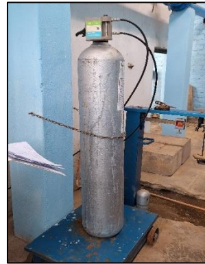
Cilindro de cloro gaseoso
