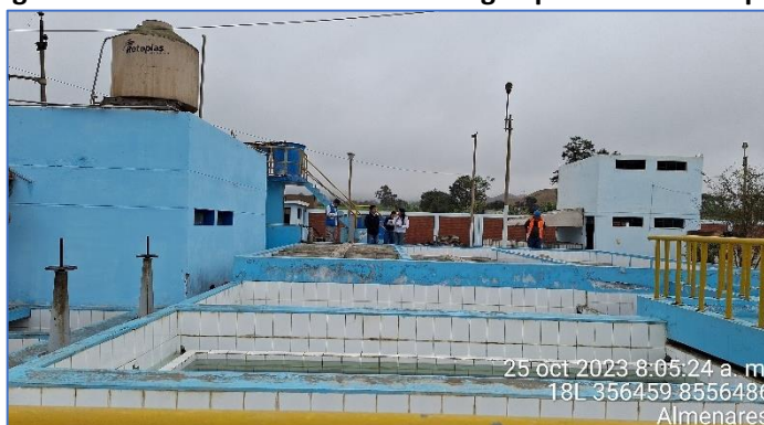
Imagen N° 8: Planta de tratamiento de agua potable N°1 - Imperial
