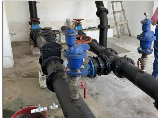
Infraestructura hidráulica – Colina Blanca
