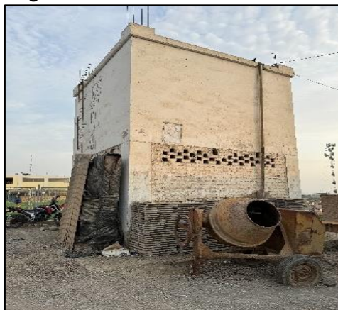
Imagen N° 9: Reservorio Elevado - San Luis
