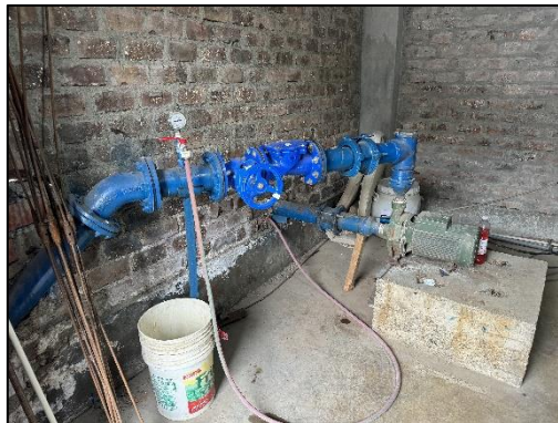
Imagen N° 22: Estación de Bombeo Las Viñas - Santa Cruz de Flores
