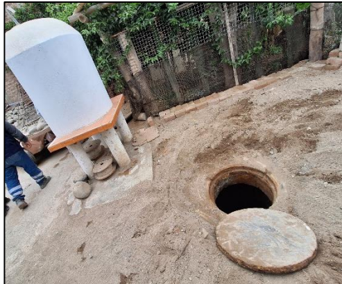
Cámaras de bombeo de desagüe Colón
