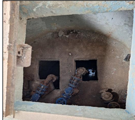
Cámaras de bombeo de desagüe Hualcará
