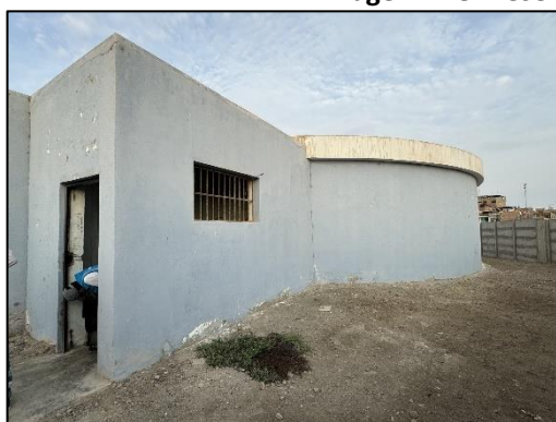
Reservorio apoyado San Luis
