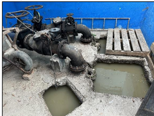
Imagen N° 29: Cámara de bombeo - Mala
