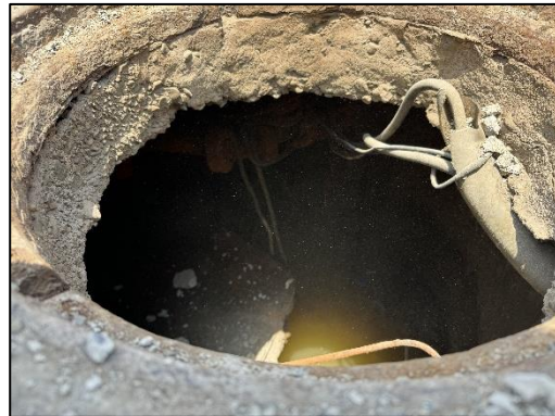
Cámara de bombeo secundaria
