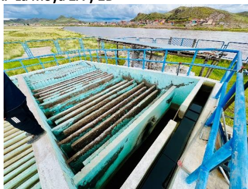
Floculadores deteriorados – PTAP La Moya 2A
