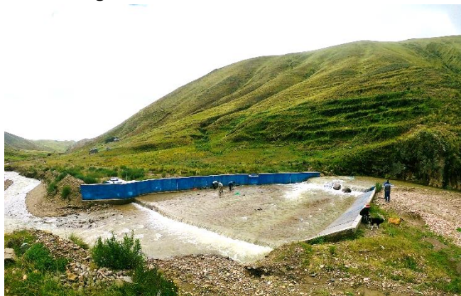
Imagen N° 14: Galería filtrante Punco Punco 1
