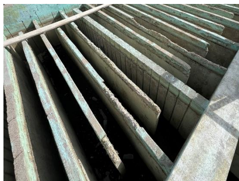
Floculadores deteriorados – PTAP La Moya 2B
