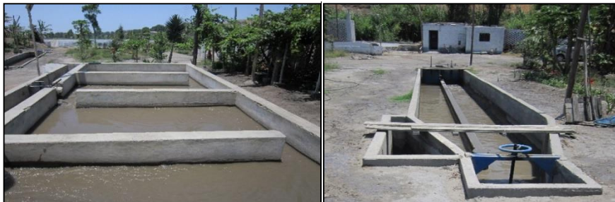
Imagen N° 9: Pre desarenador y desarenador
