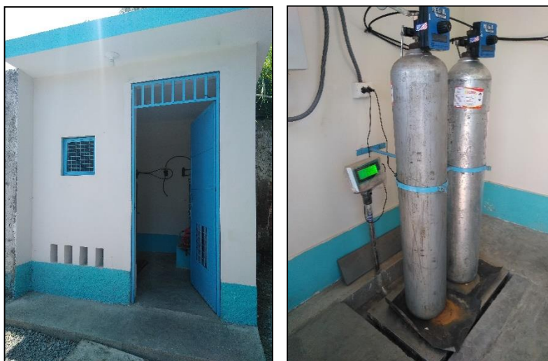
Imagen N° 18: Caseta de Cloración
