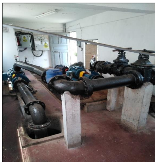
Imagen N° 26: Estación de bombeo
