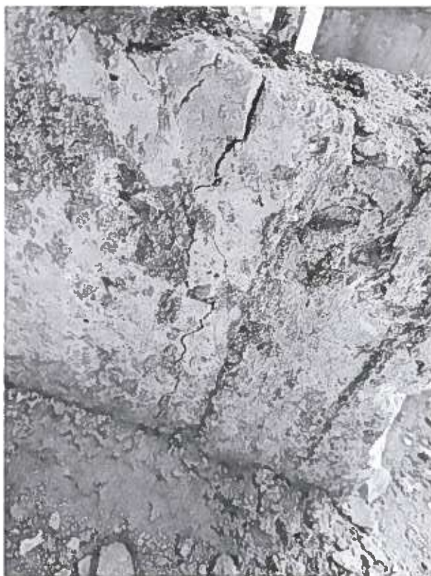
Imagen N.º 09: Se observa presencia de fisuras en sobrecimiento del bloque N.º 16.
