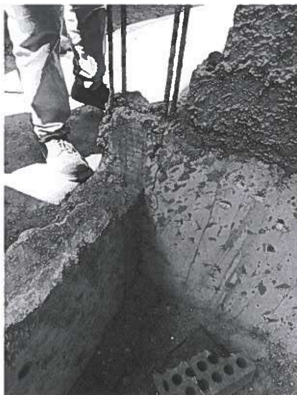
Imagen N.º 08: Se observa el mal acabado del concreto en sobrecimientos del bloque N.º 16.
