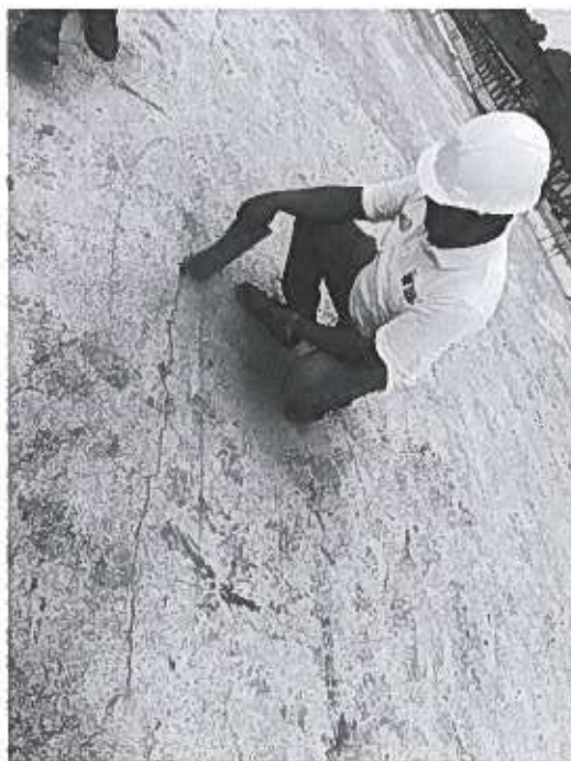
Imagen N.º 47: Se observa las fisuras en la losa aligera del primer nivel del bloque N.º 06.
