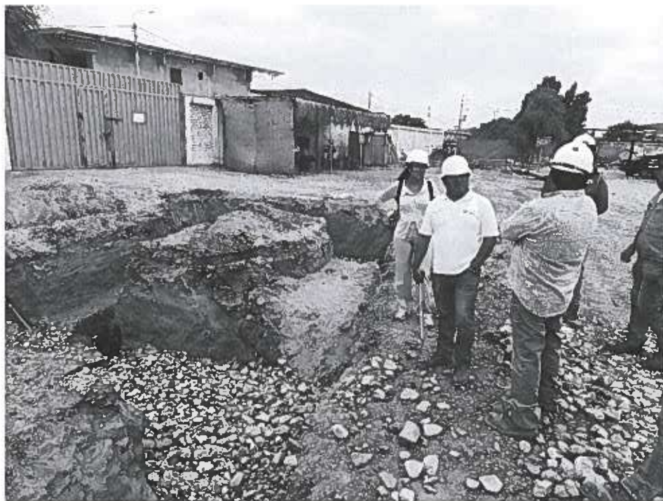
Imagen N.º 57: Se verifica la falta de señalización de seguridad en la excavación en el bloque N.º 01.
