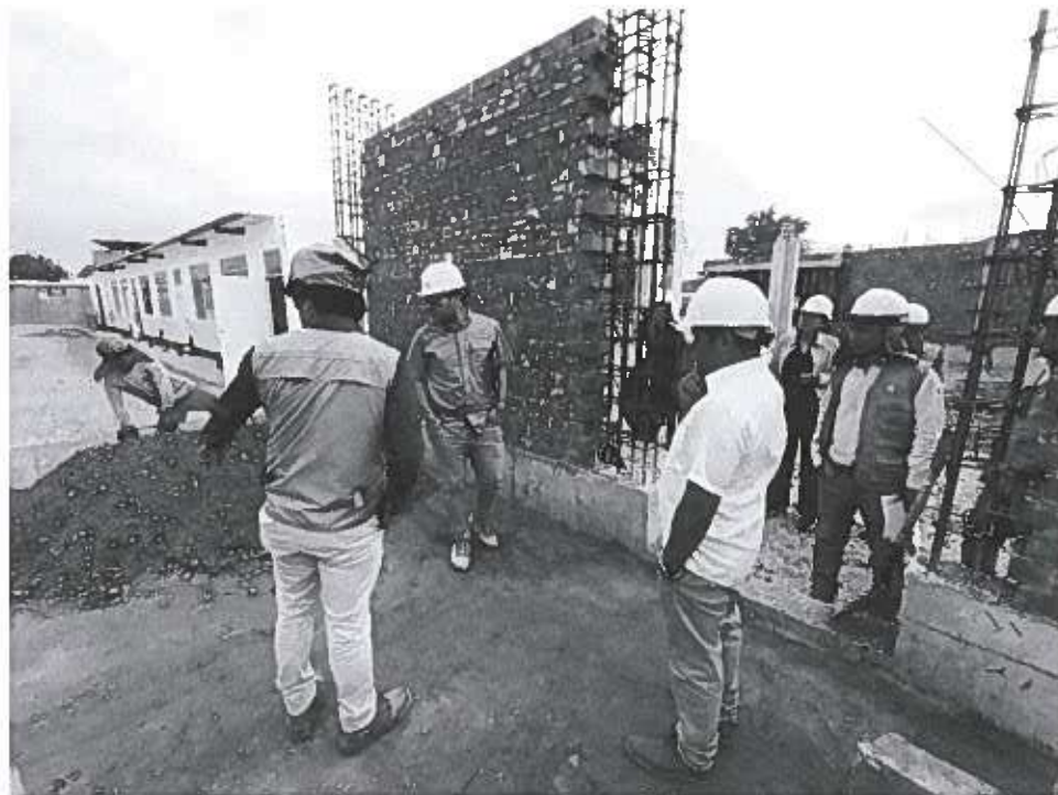
Imagen N.º 29: Se observa el desnivel y no homogeneidad en la compactación en el material de relleno propio del bloque N.º 09.
