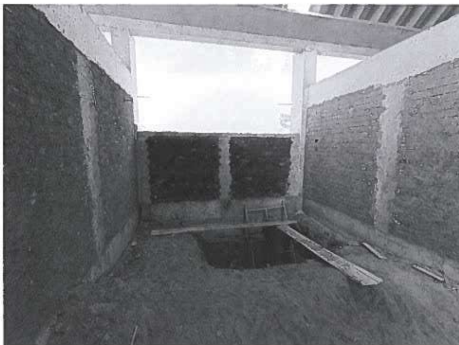
Imagen N.º 07: Se visualiza la ausencia de señalización de seguridad.
