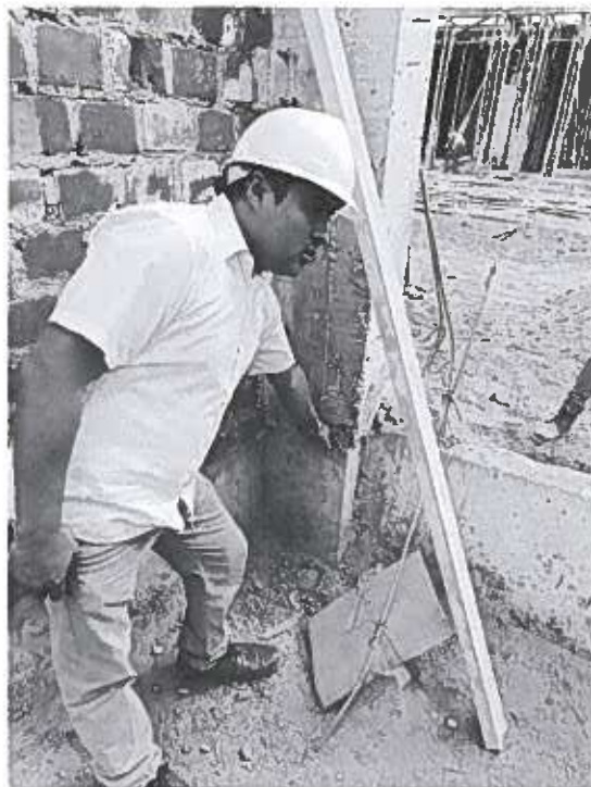
Imagen N.º 16: Se observa presencia de cangrejas en la columna del bloque N.º 09.
