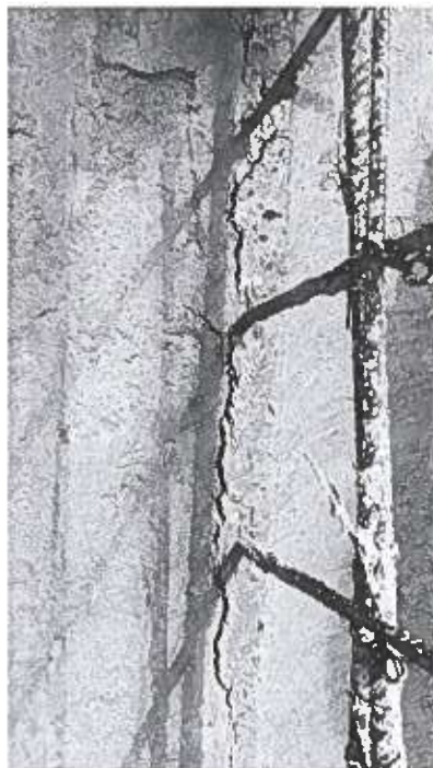
Imagen N.º 35: Se verifica las fisuras a lo largo de la viga de cimentación del bloque N.º 14.
