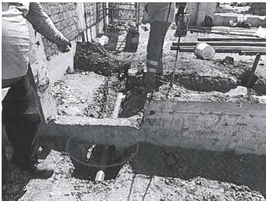
Imagen N.º 11: Se visualiza el mal proceso constructivo en instalaciones sanitarias.
