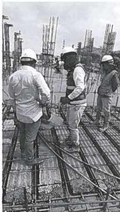
Imagen N.º 39: Se observa que los ladrillos de techo no han sido previamente humedecidos antes del vaciado de concreto de la losa aligerada para evitar absorba la humedad del mismo.
