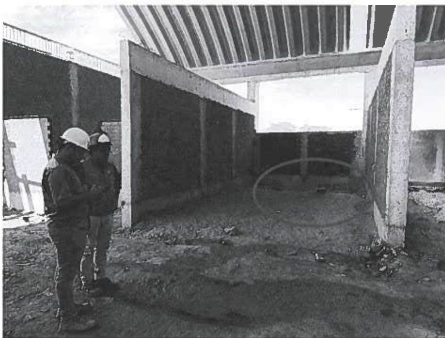
Imagen N.º 06: Se observa la falta de señalización temporal de seguridad en excavaciones.
