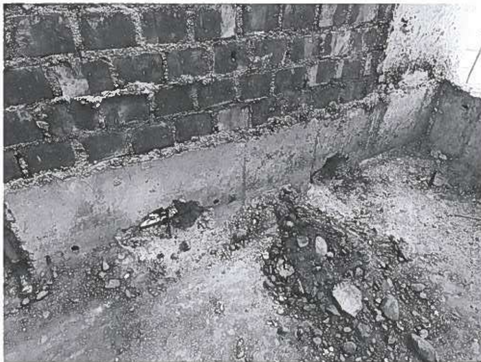
Imagen N.º 21: Se visualiza el mal proceso constructivo para las instalaciones sanitarias del bloque N.º 15.
