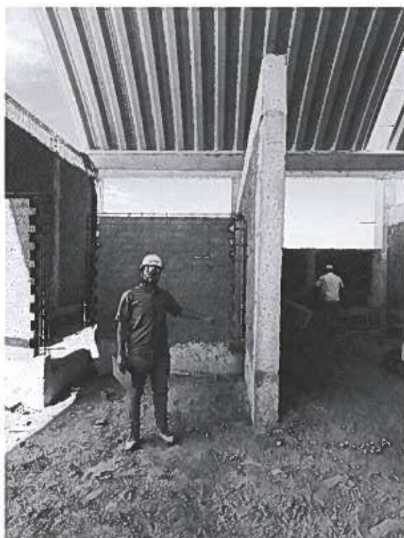
Imagen N.º 05: Se observa que algunas columnas dentro del bloque N.º 16 no presentan verticalidad (pandeadas).
