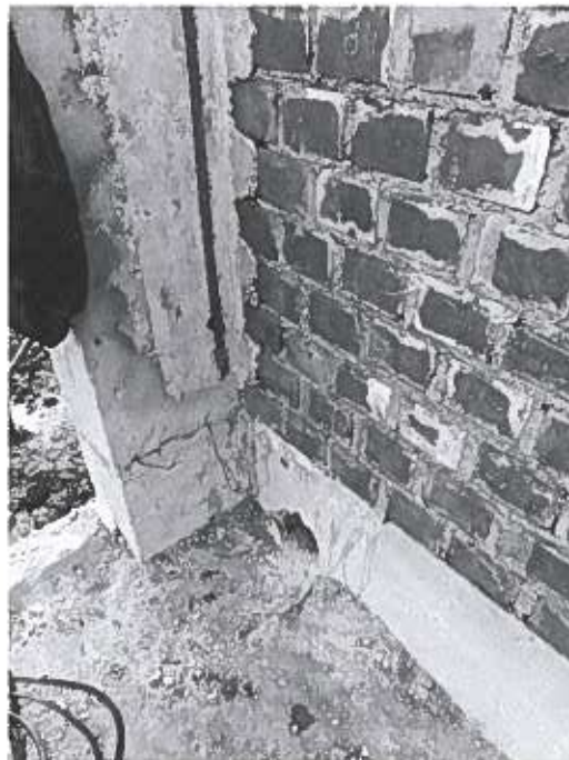
Imagen N.º 19: Se verifica la rotura del sobrecimiento del eje V` del bloque N.º 09.
