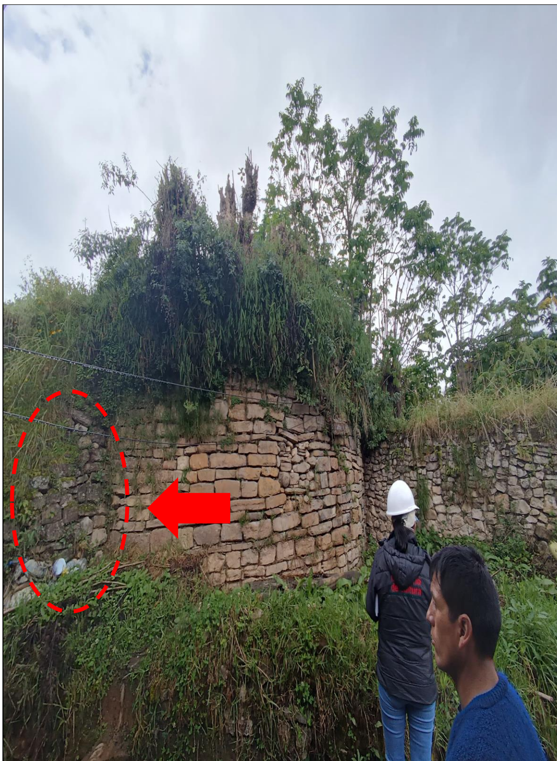
Vista de detalle del colapso del muro.
