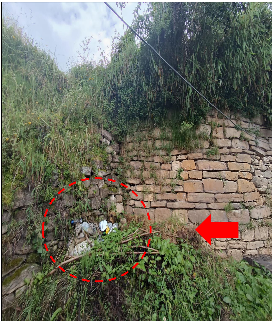
Detalle de basura (colchón negro) y cables del mismo color cruzando por el muro.
