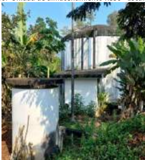
Imagen N° 36: Unidad de almacenamiento R850 - Localidad Saposoa
