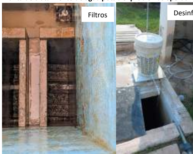
Imagen N° 75: Planta de tratamiento de agua potable: problemas operativos - Localidad Picota
