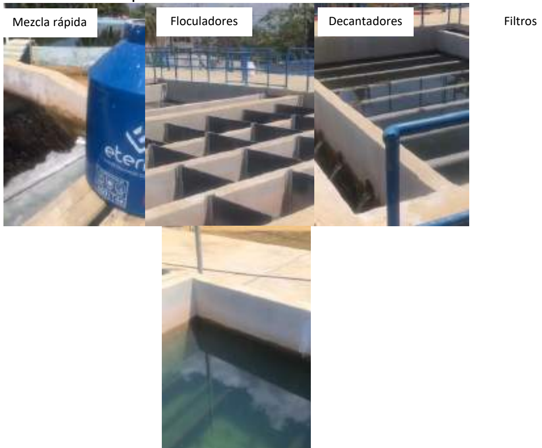
Imagen N° 18: Planta de tratamiento de agua potable: Cachiyacu 2 - Localidad Tarapoto
