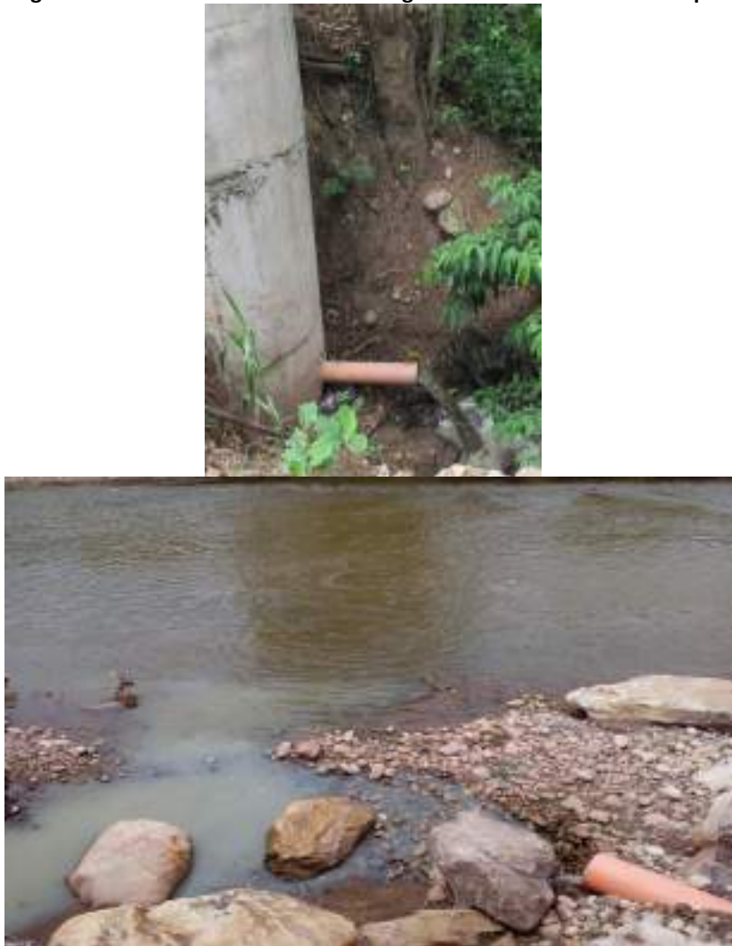
Imagen N° 39: Punto de vertimiento de aguas residuales - Localidad Saposoa
