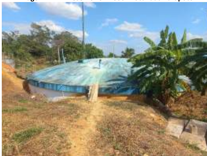
Imagen N° 27: Reservorio R2800 - Localidad Tarapoto
