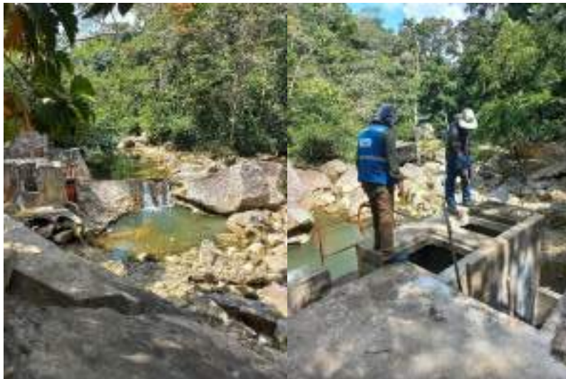
Imagen N° 5: Captación Ahuashiyacu - Localidad Tarapoto
