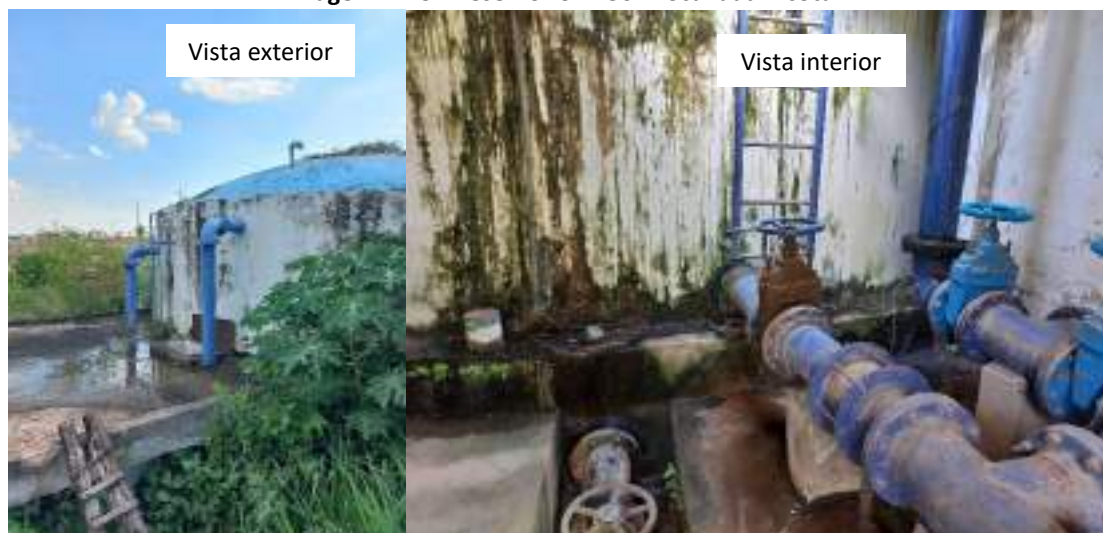
Imagen N° 79: Reservorio R250 - Localidad Picota
