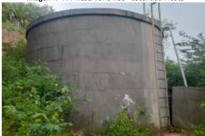
Imagen N° 77: Reservorio R80 - Localidad Picota
