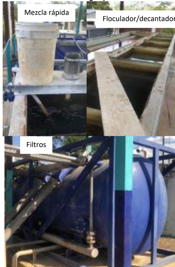
Imagen N° 21: Planta de tratamiento de agua potable Cumbaza - Localidad Tarapoto
