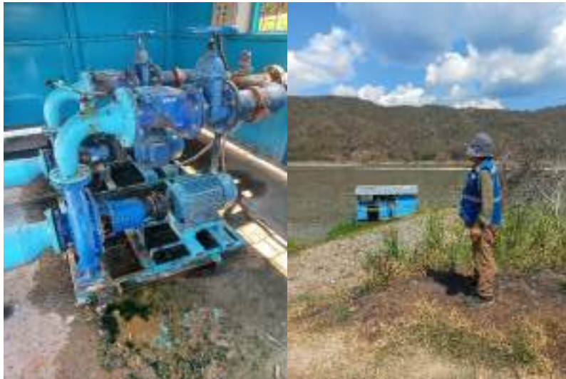
Imagen N° 59: Captación río Huallaga - Localidad Bellavista
