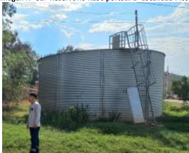
Imagen N° 81: Reservorio R250 portátil 1- Localidad Picota
