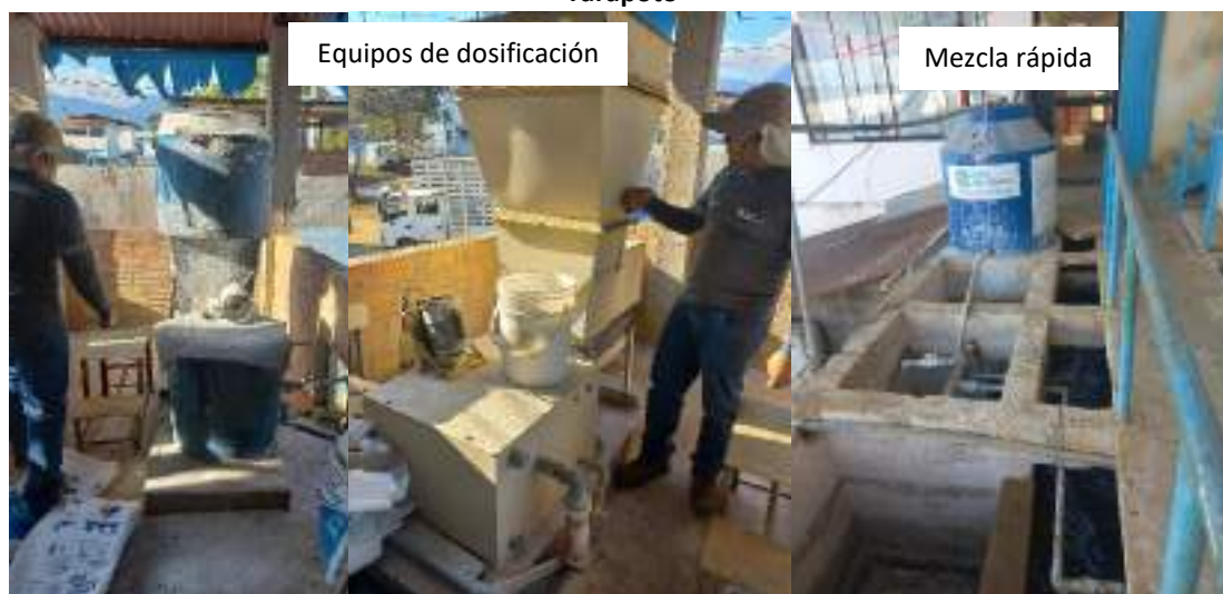
Imagen N° 13: Planta de tratamiento de agua potable: Sala de dosificación Shilcayo - Localidad Tarapoto
