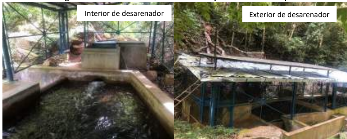
Imagen N° 11: Unidades de desarenación Cachiyacu - Localidad Tarapoto
