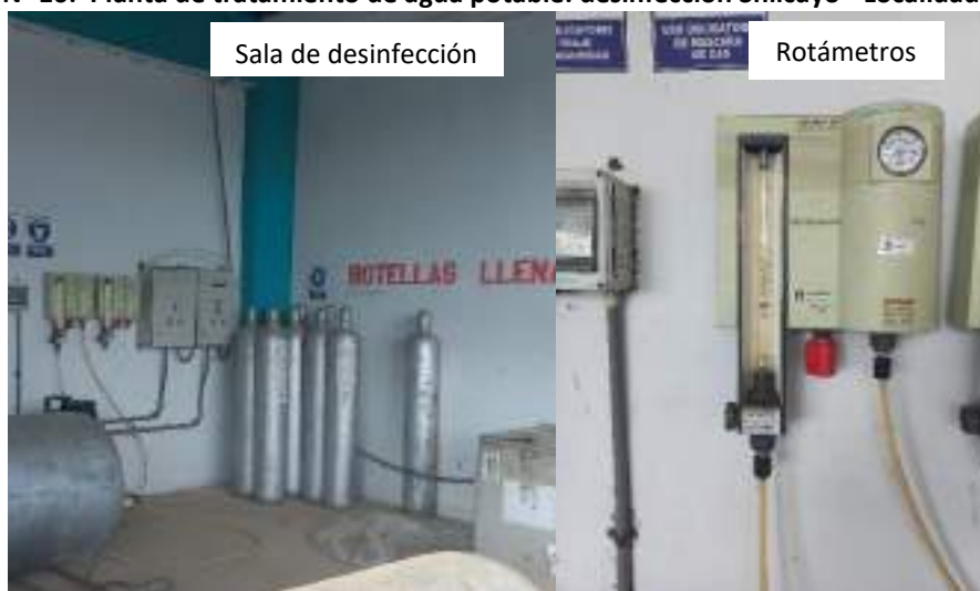
Imagen N° 16: Planta de tratamiento de agua potable: desinfección Shilcayo - Localidad Tarapoto
