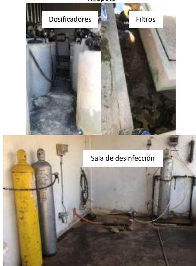
Imagen N° 22: Planta de tratamiento de agua potable Cumbaza: Problemas técnicos - Localidad Tarapoto
