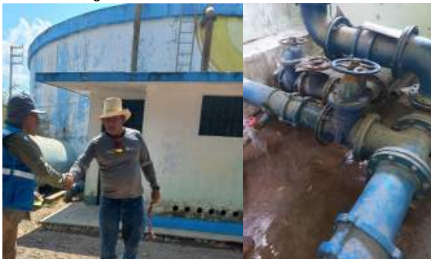
Imagen N° 64: Reservorio R1100 - Localidad Bellavista
