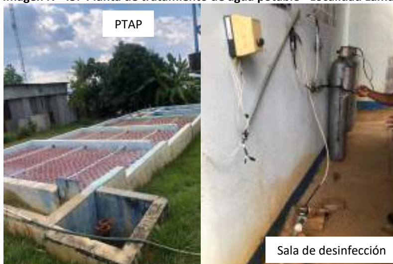
Imagen N° 45: Planta de tratamiento de agua potable - Localidad Lamas
