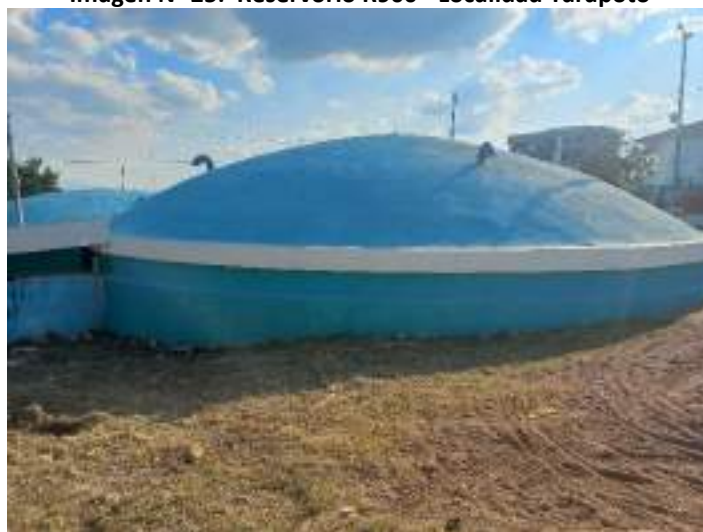
Imagen N° 25: Reservorio R900 - Localidad Tarapoto
