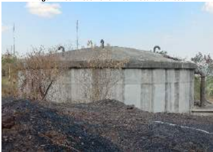
Imagen N° 83: Reservorio R100 - Localidad Picota
