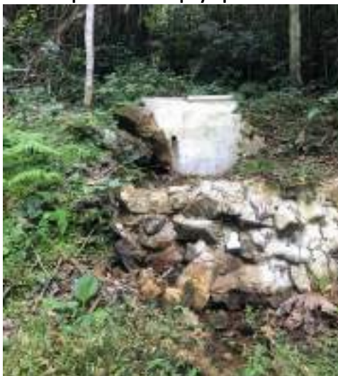
Imagen N° 42: Captación Mishquiyaquillo 1- Localidad Lamas
