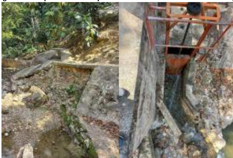
Imagen N° 6: Captación Ahuashiyacu: Problemas técnicos - Localidad Tarapoto
