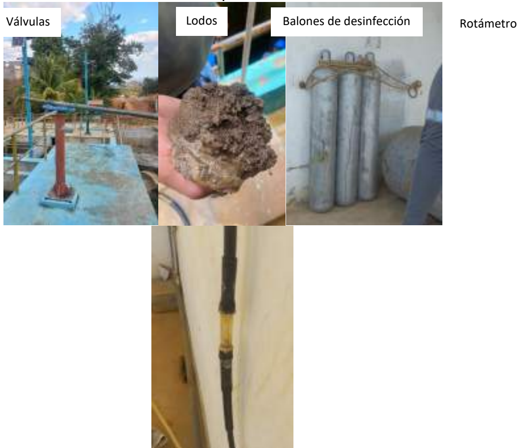
Imagen N° 20: Planta de tratamiento de agua potable Ahuashiyacu: Problemas operativos - Localidad Tarapoto
