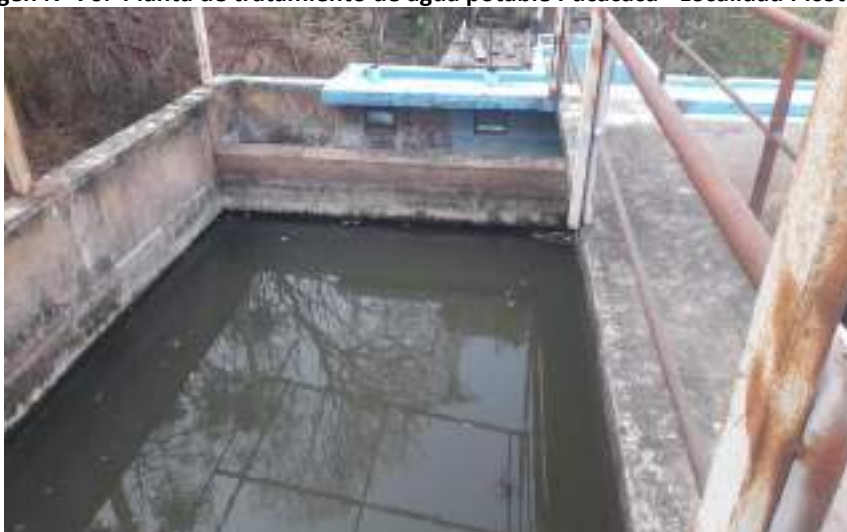
Imagen N° 76: Planta de tratamiento de agua potable Pucacaca - Localidad Picota
