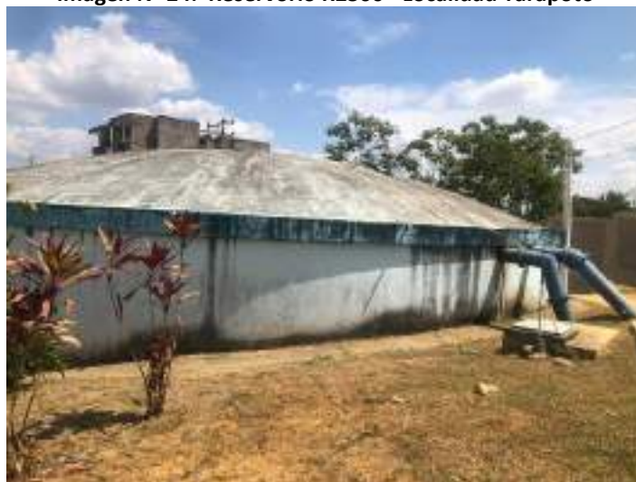
Imagen N° 24: Reservorio R2500 - Localidad Tarapoto
