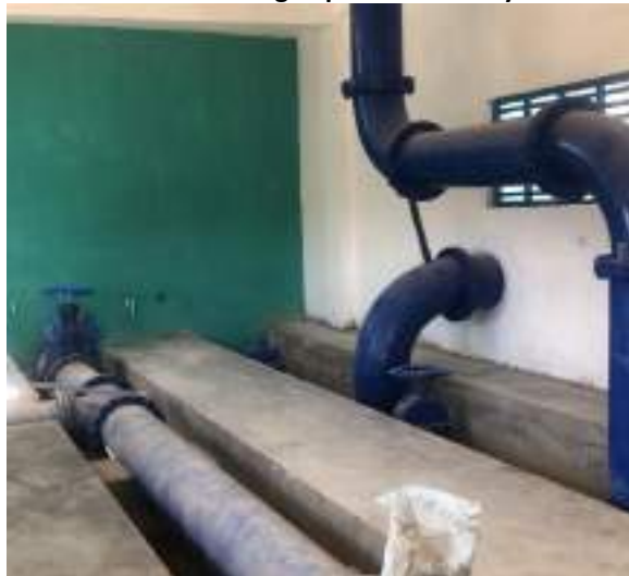
Imagen N° 23: Estación de bombeo de agua potable: Shilcayo 3250 - Localidad Tarapoto
