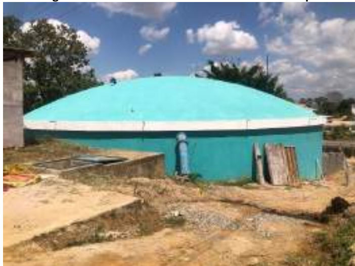
Imagen N° 26: Reservorio R3250 - Localidad Tarapoto
