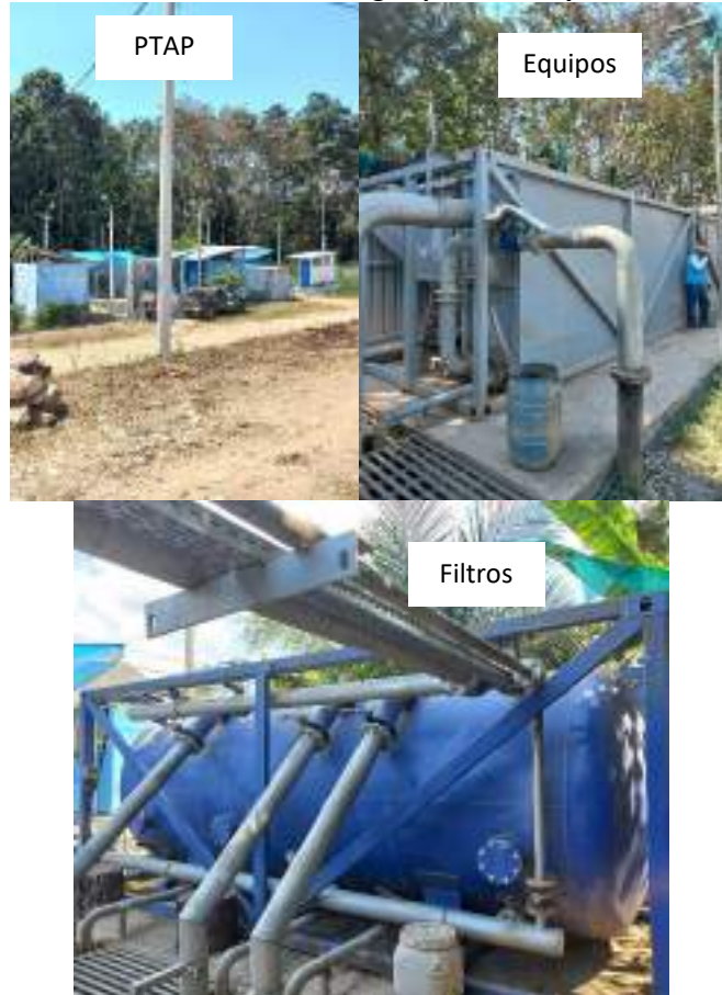
Imagen N° 61: Planta de tratamiento de agua potable Intiyacu - Localidad Bellavista
