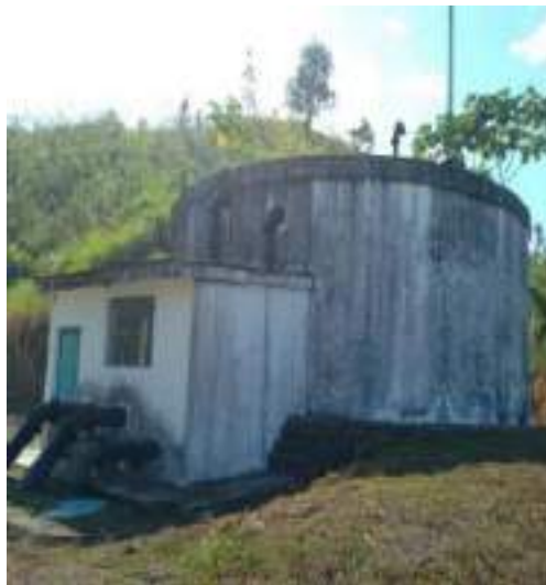
Imagen N° 37: Unidad de almacenamiento R600 - Localidad Saposoa
