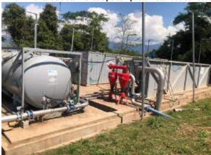
Imagen N° 54: Planta de tratamiento tipo compacta- Localidad San José de Sisa
