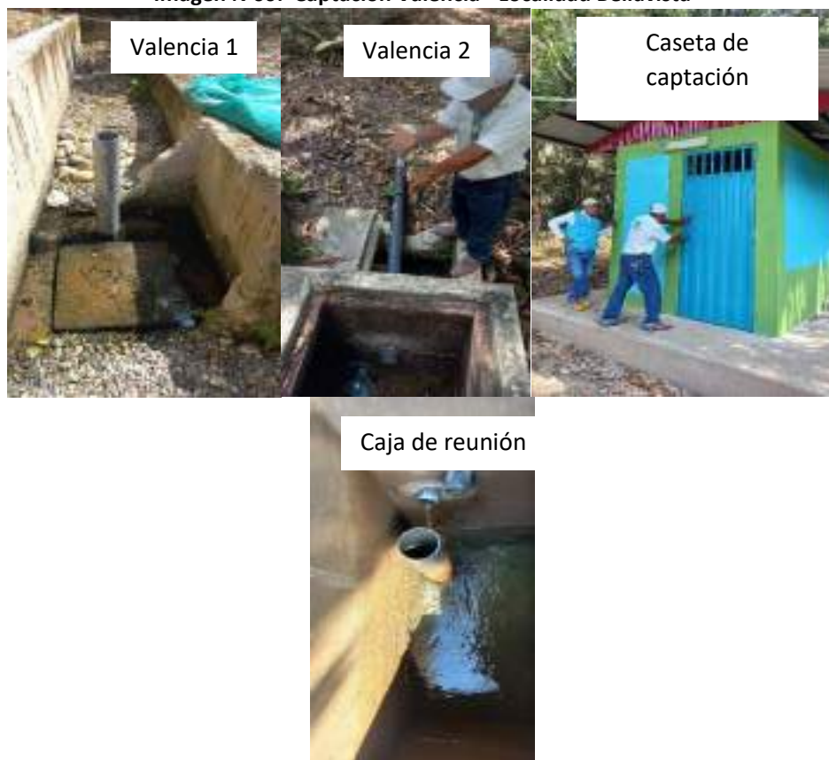
Imagen N 60: Captación Valencia - Localidad Bellavista
