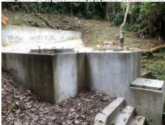
Imagen N° 43: Captación Mishquiyaquillo 2- Localidad Lamas
