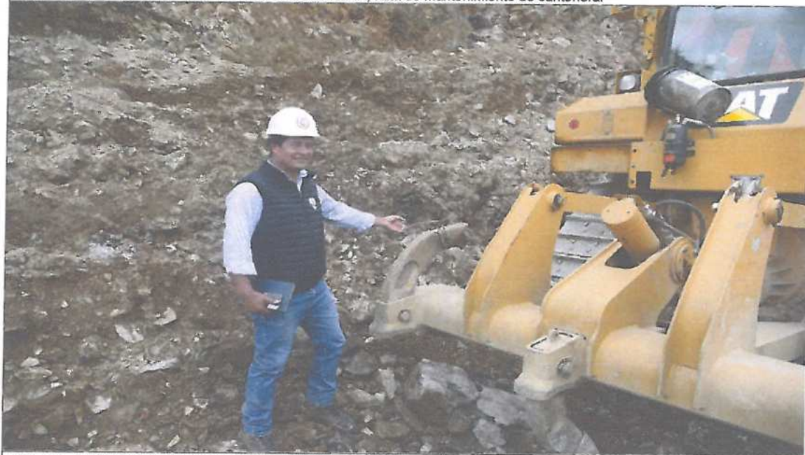
IMG. 17.- EI TRACTOR ORUGA D6TXL CATERPILLAR, falta de mantenimiento uñas ripper.
