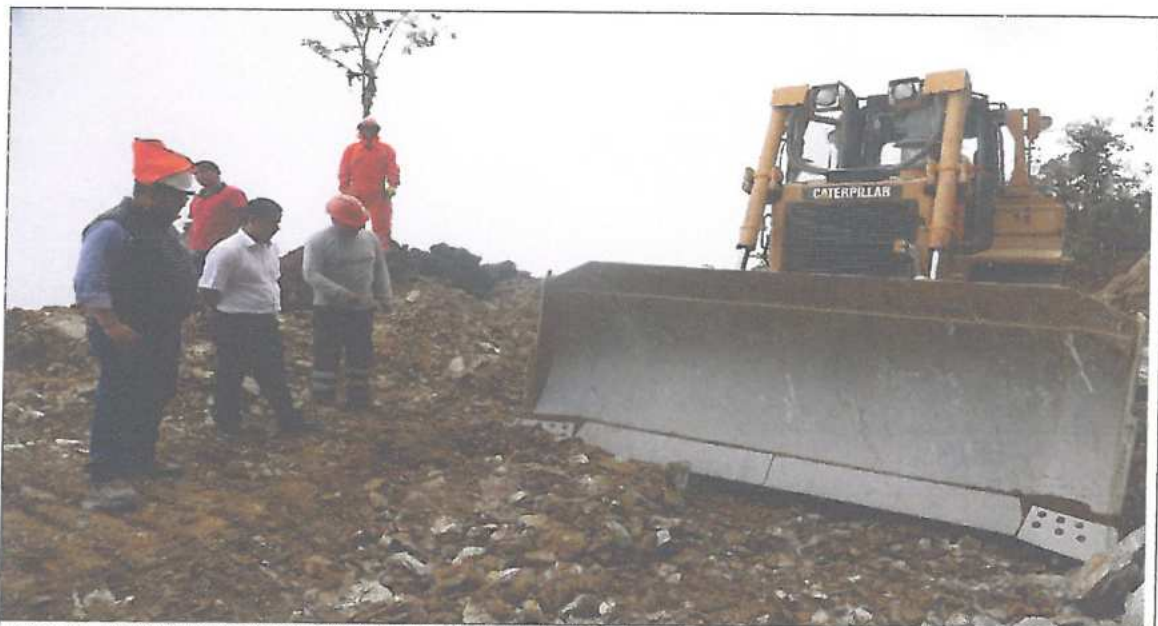
IMG. 16.- EI TRACTOR ORUGA D6TXL CATERPILLAR, falta de mantenimiento de cantonera.
