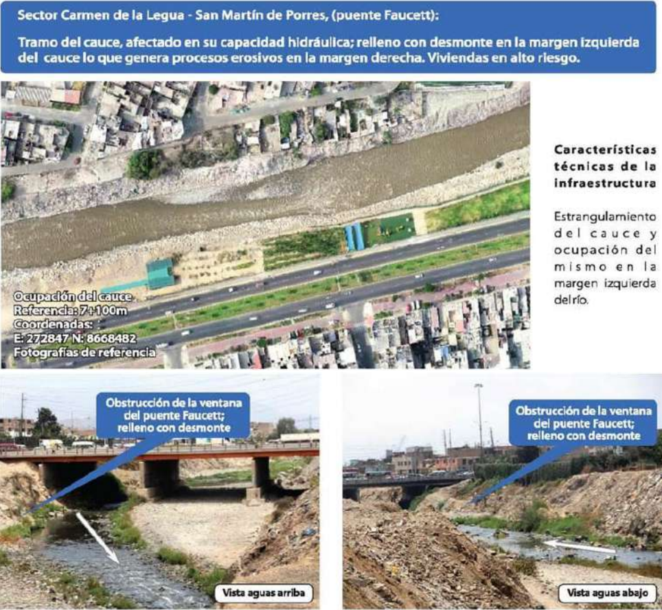
Figura 177. Afectación de faja marginal, riberas y cauce rio Rímac – Callao
