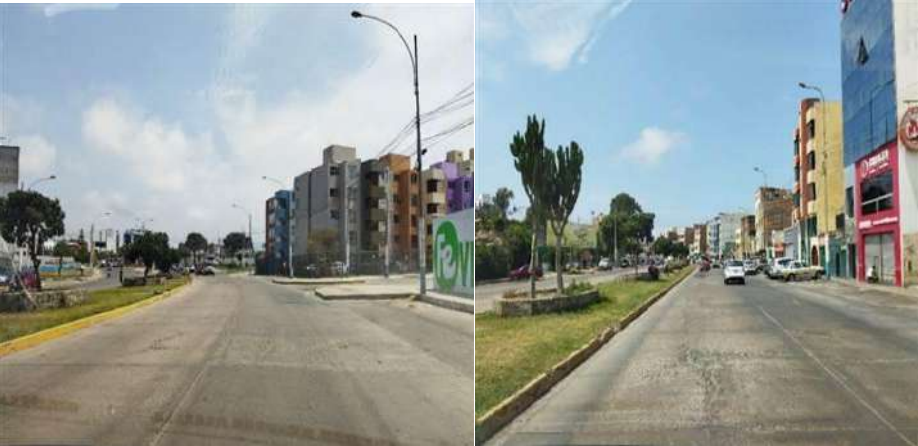
Figura 92. Estado de conservación Av. Haya de la Torre: Tramo Av. La Libertad – Av. Pacífico
