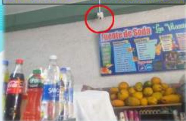
CÁMARA DE VIDEO VIGILANCIA
