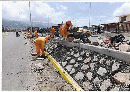
Trabajos de emboquillado con Concreto ciclópeo f_c = 175 \text{ kg/cm}^2 en separador lateral, prog. 4+200 - 4+360.
