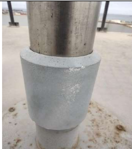
Figura 6. Tubo de muestreo, acople de plástico y conducto de acero fijado al techo.
