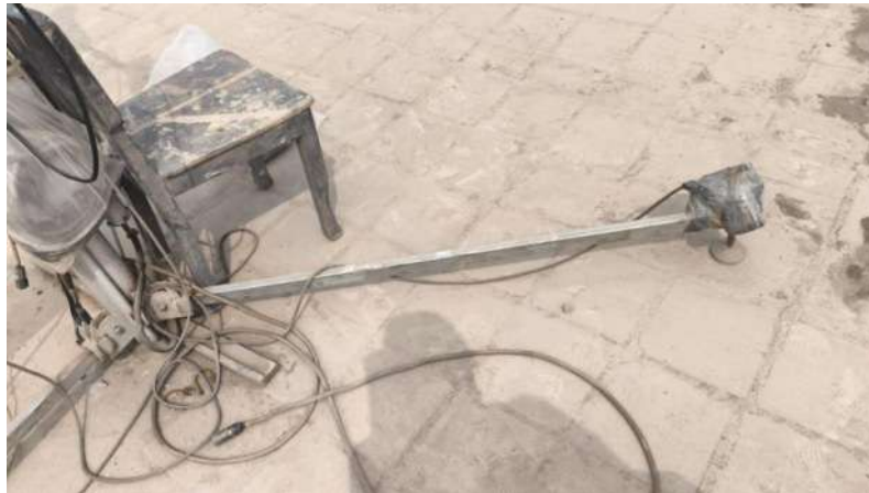
Figura 3. Instalación del mástil Maigrai (modelo RAI-M02)
