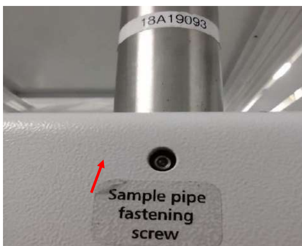
Figura 13. Muestra del “sample pipe fastening screw” o tornillo de fijación.
