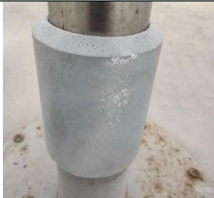
Figura 11. Acople en la parte superior del shelter
