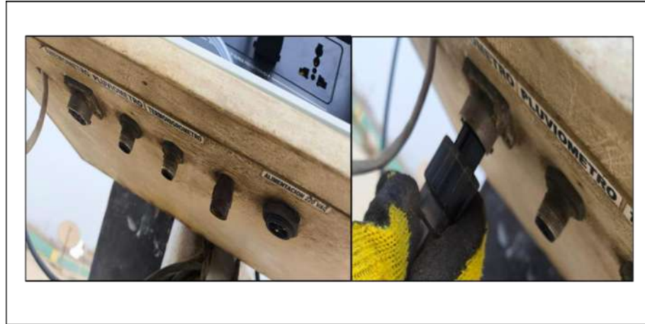
Figura 11. Conexión de sensores al Gabinete
