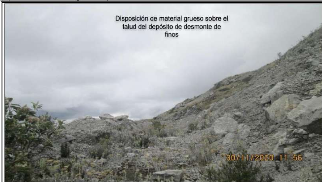
Fotografía N° 27. Disposición de material de desmonte mayor a 2" en el talud del depósito de material fino que presentaba escasa vegetación. 59
