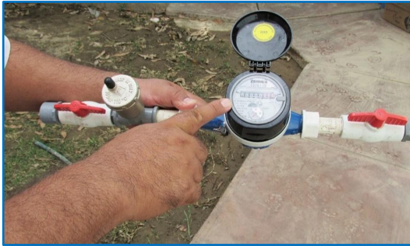
MEDIDOR PARA EL CONTROL “MICROMEDICION” DEL AGUA POTABLE EN DOMICILIOS USADOS POR LA EPS EMAPICA S.A
