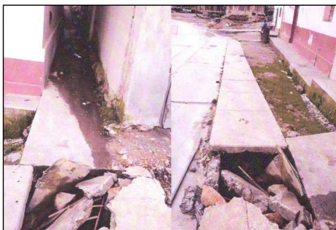
Imagen 2. Canales subterráneos en mal estado
