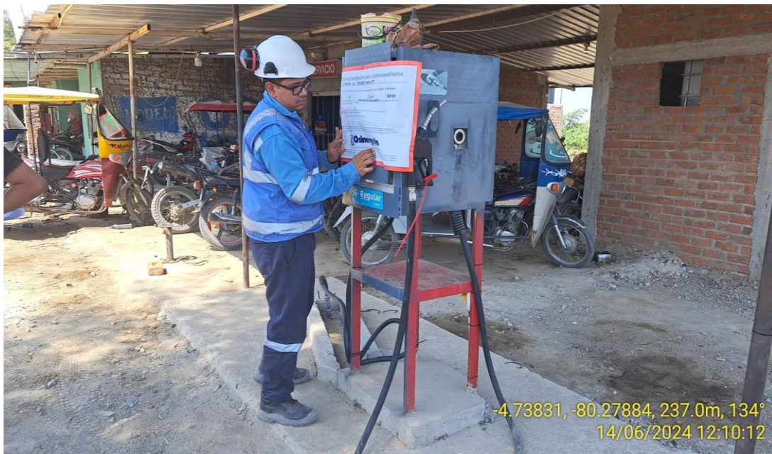
Imagen 2: Vista de la colocación de cartel de medida de seguridad, CIERRE DEL ESTABLECIMIENTO, sobre surtidor eléctrico.
