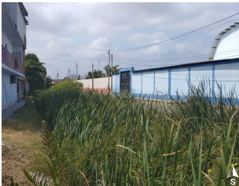
Foto N° 01: Caja Hidráulica del dren se observa totalmente colmatada con vegetación y sedimentos que genera estancamiento de sus aguas.
