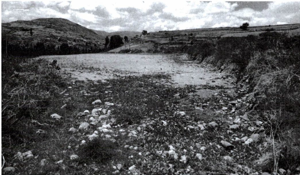
Foto.1: Vista panorámica del área de afectación donde se evidencia la nivelación de terreno con maquinaria pesada. (inspección técnica 20/11/2024).
