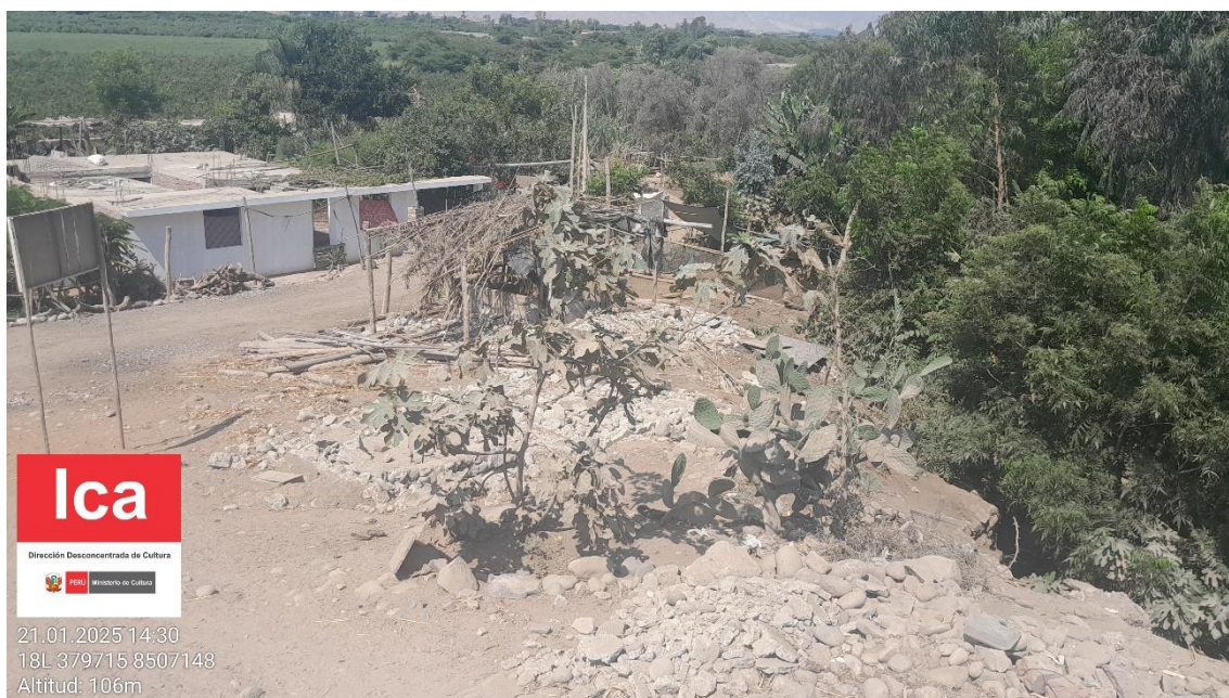
Imagen 01: vista panorámico de restos de escombros de material de concreto.
