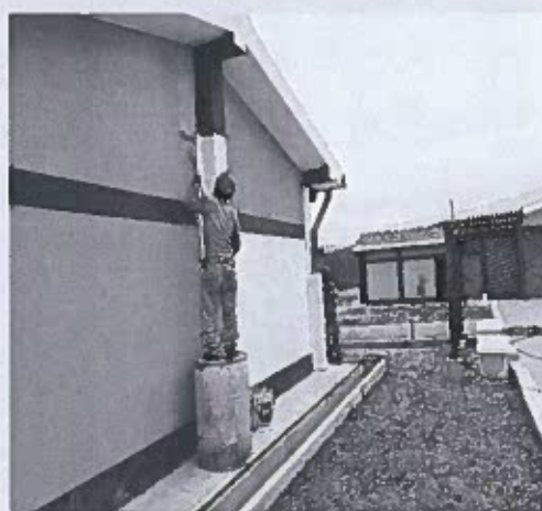
Imagen 08: Vista de levantamiento de observaciones de resanes de pintura en muros
