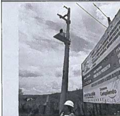
Imagen 11: Vista del poste de media tensión
