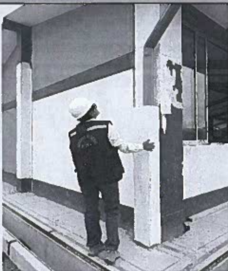
Imagen 09: Vista de levantamiento de observaciones de resanes de pintura en muros
