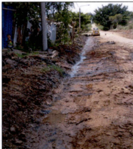
Imagen N° 09: Excavación con maquinaria irregular.
