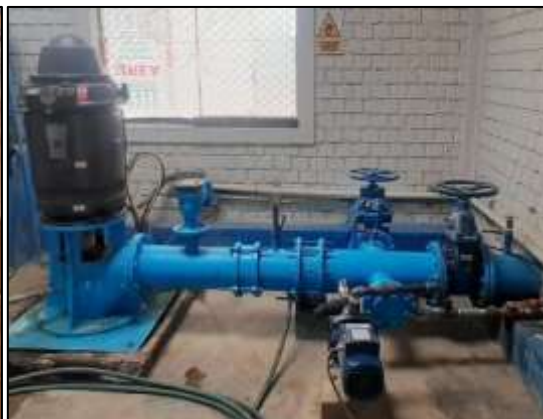
Pozo N°03: Infraestructura hidráulica
