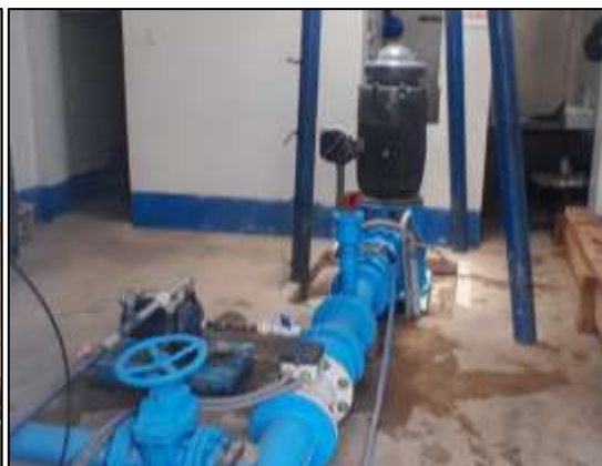
Pozo Satuca: Infraestructura hidráulica
