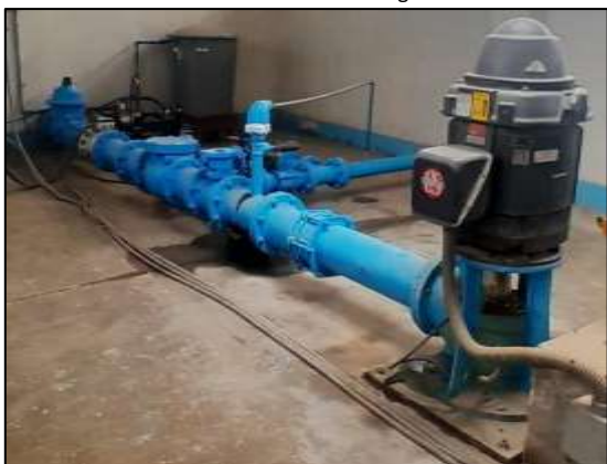
Pozo N°04 – Infraestructura Hidráulica
