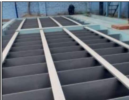
Unidad de floculación horizontal
