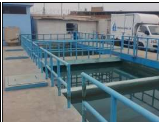
Unidad de filtración
