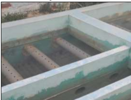
Unidad de decantación
