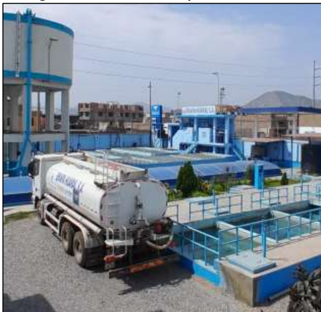
Imagen N° 10: PTAP Huando y Reservorio elevado
