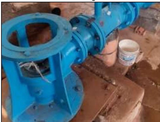
Pozo N°02 – Bomba sumergible.
