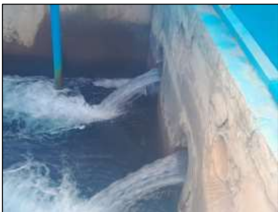
Cámara de contacto de cloro
