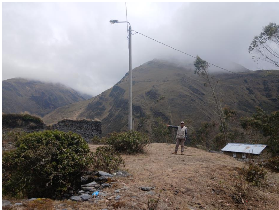
Imagen N° 21: Poste instalado sobre el posible Ushnu
