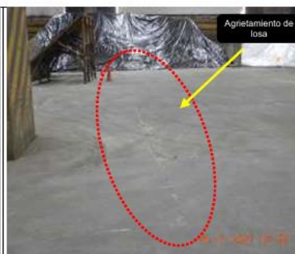
Fotografía N° 24. Vista fotográfica de la fisura ubicada en el área 13 del almacén de zinc y cobre, en la coordenada WGS 84 zona 18: 8667925N, 268143E 52 .
