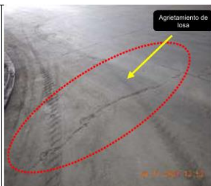
Fotografía N° 8. Vista fotográfica de la fisura ubicada en el área 5 del almacén de zinc y cobre, en la coordenada WGS 84 zona 18: 8667936N, 268278E 36 .
