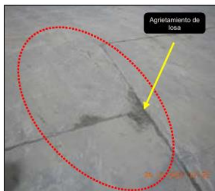
Fotografía N° 17. Vista fotográfica de la fisura ubicada en el área 10 del almacén de zinc y cobre, en la coordenada WGS 84 zona 18: 8667935N, 268195E 45 .
