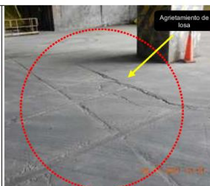
Fotografía N° 32. Vista fotográfica de las fisuras ubicadas en el área 17 del almacén de zinc y cobre, en la coordenada WGS 84 zona 18: 8667858N, 268080E 60 .
