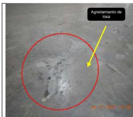
Fotografía N° 27. Vista fotográfica de la fisura ubicada en el área 15 del almacén de zinc y cobre, en la coordenada WGS 84 zona 18: 8667925N, 268114E 55 .
