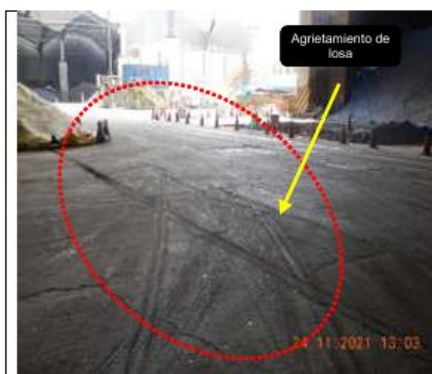
Fotografía N° 31. Vista fotográfica de las fisuras ubicadas en el área 17 del almacén de zinc y cobre, en la coordenada WGS 84 zona 18: 8667858N, 268080E 59 .
