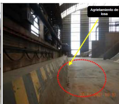
Fotografía N° 36. Vista fotográfica de la fisura ubicada en el área de pre embarque, en la coordenada WGS 84 zona 18: 8667651N, 268106E 64
