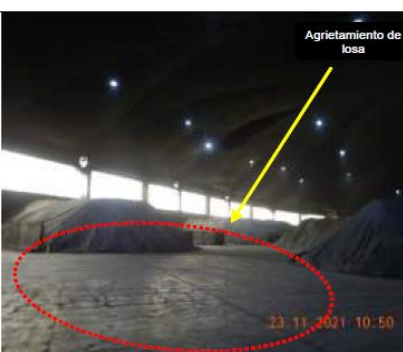
Fotografía N° 34. Vista fotográfica de las fisuras ubicada en el almacén de plomo, en la coordenada WGS 84 zona 18: 8667844N, 268253E 62 .
