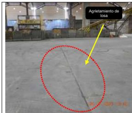
Fotografía N° 29. Vista fotográfica de la fisura ubicada en el área 16 del almacén de zinc y cobre, en la coordenada WGS 84 zona 18: 8667908N, 268107E 57 .
