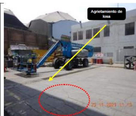
Fotografía N° 39. Vista fotográfica de las fisuras ubicadas en el taller de mantenimiento en la coordenada WGS 84 zona 18: 8667807N, 268068E 67
