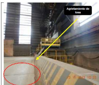
Fotografía N° 35. Vista fotográfica de la fisura ubicada en el área de pre embarque, en la coordenada WGS 84 zona 18: 8667651N, 268106E 63
