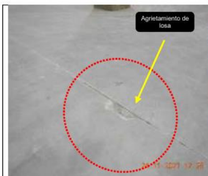
Fotografía N° 23. Vista fotográfica de la fisura ubicada en el área 13 del almacén de zinc y cobre, en la coordenada WGS 84 zona 18: 8667925N, 268143E 51 .
