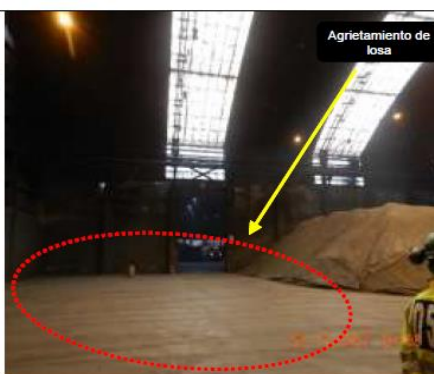
Fotografía N° 38. Vista fotográfica de las fisuras ubicadas en el anexo de pre embarque, en la coordenada WGS 84 zona 18: 8667816N, 268145E 66
