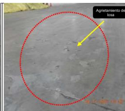
Fotografía N° 28. Vista fotográfica de la fisura ubicada en el área 15 del almacén de zinc y cobre, en la coordenada WGS 84 zona 18: 8667925N, 268114E 56 .
