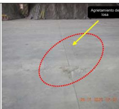
Fotografía N° 10. Vista fotográfica de la fisura ubicada en el área 6 del almacén de zinc y cobre, en la coordenada WGS 84 zona 18: 8667937N, 268266E 38 .
