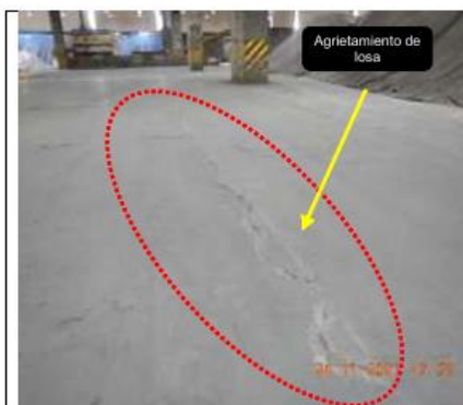
Fotografía N° 25. Vista fotográfica de la fisura ubicada en el área 14 del almacén de zinc y cobre, en la coordenada WGS 84 zona 18: 8667922N, 268135E 53 .
