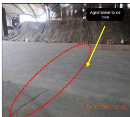
Fotografía N° 9. Vista fotográfica de la fisura ubicada en el área 6 del almacén de zinc y cobre, en la coordenada WGS 84 zona 18: 8667936N, 268278E 37 .
