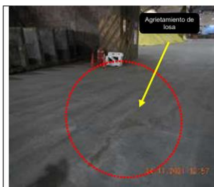
Fotografía N° 19. Vista fotográfica de la fisura ubicada en el área 11 del almacén de zinc y cobre, en la coordenada WGS 84 zona 18: 8667922N, 268182E 47 .
