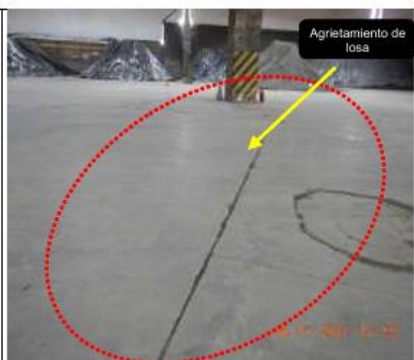
Fotografía N° 16. Vista fotográfica de la fisura ubicada en el área 9 del almacén de zinc y cobre, en la coordenada WGS 84 zona 18: 8667937N, 268210E 44 .
