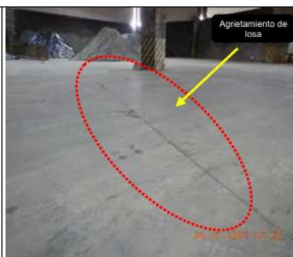
Fotografía N° 18. Vista fotográfica de la fisura ubicada en el área 10 del almacén de zinc y cobre, en la coordenada WGS 84 zona 18: 8667935N, 268195E 46 .
