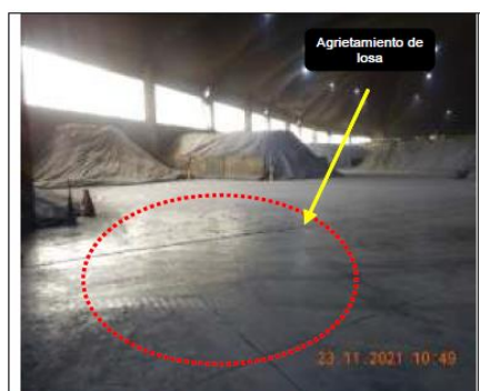
Fotografía N° 33. Vista fotográfica de las fisuras ubicadas en el almacén de plomos, en la coordenada WGS 84 zona 18: 8667844N, 268253E 61 .
