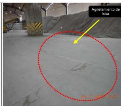
Fotografía N° 26. Vista fotográfica de la fisura ubicada en el área 14 del almacén de zinc y cobre, en la coordenada WGS 84 zona 18: 8667922N, 268135E 54 .
