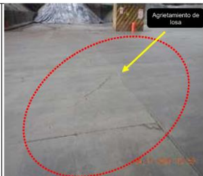
Fotografía N° 12. Vista fotográfica de la fisura ubicada en el área 7 del almacén de zinc y cobre, en la coordenada WGS 84 zona 18: 8667942N, 268236E 40 .
