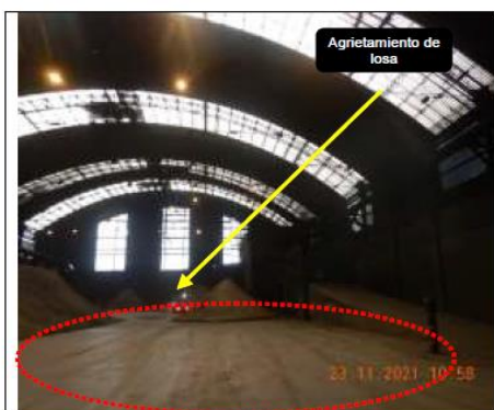
Fotografía N° 37. Vista fotográfica de las fisuras ubicadas en el anexo de pre embarque en la coordenada WGS 84 zona 18: 8667816N, 268145E 65
