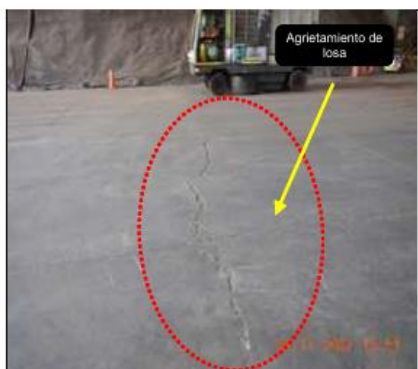
Fotografía N° 7. Vista fotográfica de la fisura ubicada en el área 5 del almacén de zinc y cobre, en la coordenada WGS 84 zona 18: 8667931N, 268284E 35 .
