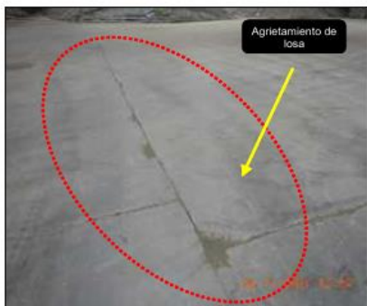
Fotografía N° 13. Vista fotográfica de la fisura ubicada en el área 8 del almacén de zinc y cobre, en la coordenada WGS 84 zona 18: 8667929N, 268218E 41 .
