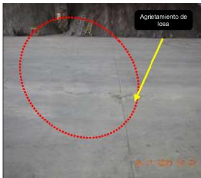
Fotografía N° 11. Vista fotográfica de la fisura ubicada en el área 7 del almacén de zinc y cobre, ubicado en la coordenada WGS 84 zona 18: 8667937N, 268266E 39 .
