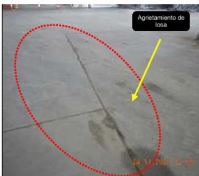
Fotografía N° 15. Vista fotográfica de la fisura ubicada en el área 9 del almacén de zinc y cobre, en la coordenada WGS 84 zona 18: 8667937N, 268210E 43 .
