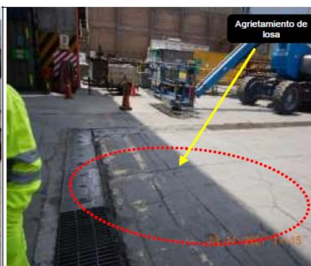
Fotografía N° 40. Vista fotográfica de las fisuras ubicadas en el taller de mantenimiento, en la coordenada WGS 84 zona 18: 8667807N, 268068E 68
