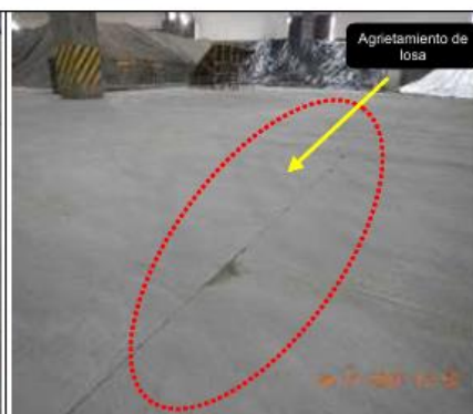
Fotografía N° 22. Vista fotográfica de la fisura ubicada en el área 12 del almacén de zinc y cobre, en la coordenada WGS 84 zona 18: 8667921N, 268164E 50 .
