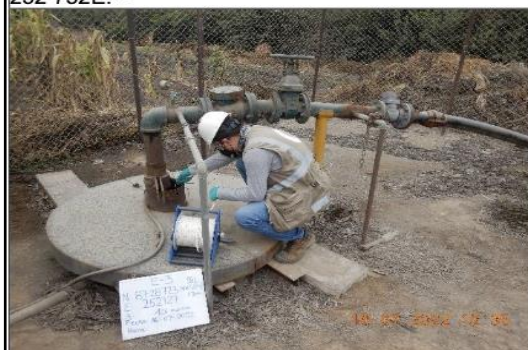
Fotografía N° 27. Ubicación en campo de la Estación E-3 el cual se encontraba en el Pozo Tubular N° 1. Con coordenadas UTM WGS 8 728 723N 252 727E. 64
