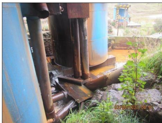
Fotografía N° 11 37 Vista donde se observa el talud rocoso adyacente a la planta con vegetación, el cual se encontraba humedecido por salpicaduras del agua del rebose
