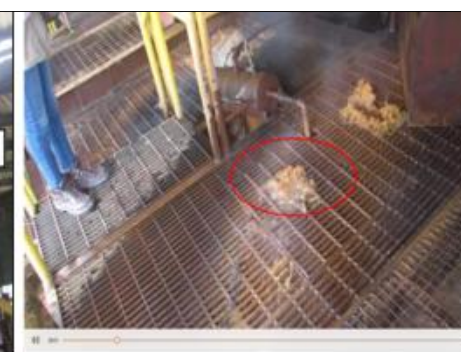
Fotografía N° 834 Vista donde se observa el tanque N° 2 rebosando su capacidad saliendo el agua a través de las rejillas hacia el suelo de la PTAA Acchilla.
