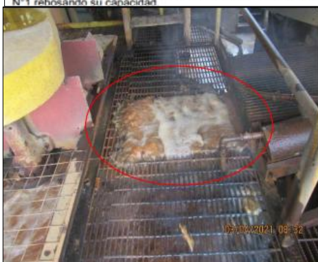
Fotografía N° 935 Vista donde se observa del tanque N° 2 al tanque N° 3 rebosando su capacidad por encima de las rejillas
