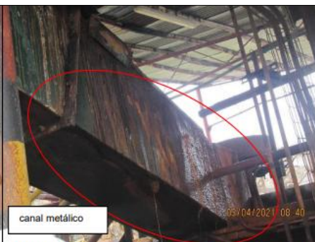
Fotografía N° 632 Vista donde se observa el canal metálico que conduce el agua ácida hacia el tanque N° 1 para el tratamiento, el cual se encontraba rebosando y discuriendo por las paredes del mismo.
