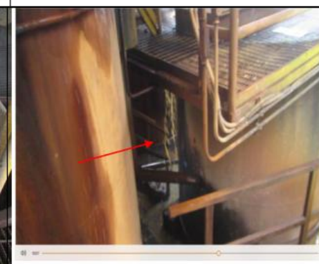
Fotografía N° 1036 Vista donde se observa del tanque N° 3 rebosando su capacidad discuriendo hacia la base de la PTAA Acchilla
