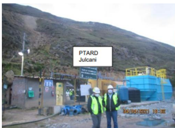
Fotografía N° 58 159 : Vista donde se observa la PTARD Julcani ubicada en las coordenadas (Datum WGS 84, zona 18L):521 014E, 8 568 787N.)
