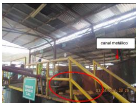
Fotografía N° 733 Vista donde se observa el canal metálico que conduce el agua ácida hacia el tanque N° 1 para el tratamiento, el cual se encontraba rebosando y discuriendo por las paredes del mismo, asimismo se observa el tanque N° 1 rebosando su capacidad.
