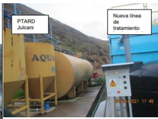
Fotografía N° 59 160 : Vista donde se observa la PTARD Julcani ubicada en las coordenadas (Datum WGS 84, zona 18L):521 014E, 8 568 787N y paralela la línea de tratamiento implementada por Buenaventura
