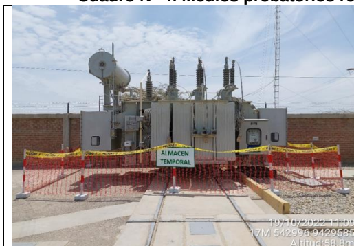
Fotografía N° 90: Transformador N° 5 de la S.E.T. Ejidos.
