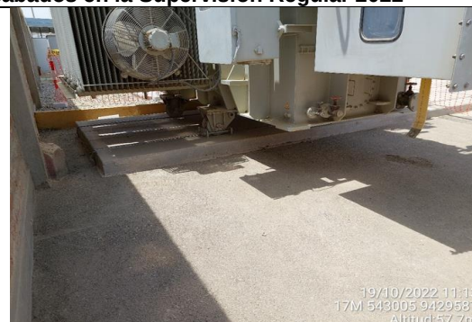
Fotografía N° 93: Transformador N° 5 de la S.E.T. Ejidos.
