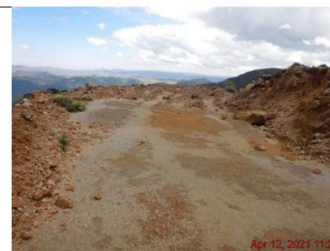
Fotografía N° 152: Vista del área correspondiente a la plataforma P110, se observa corte del terreno, área disturbada y erosión hídrica. (Fotografía DSCN7337)
