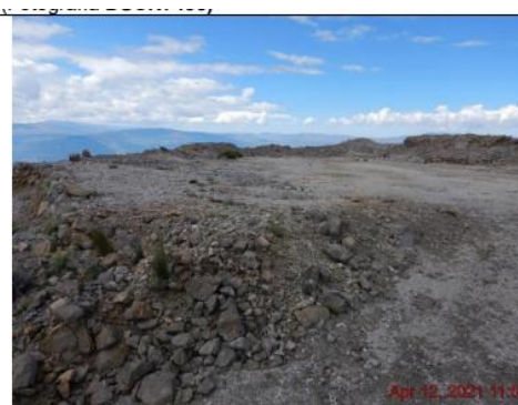
Fotografía N° 160: Vista del área correspondiente a la plataforma P152, se observa corte del terreno, área disturbada y erosión hídrica. (Fotografía DSCN7293)
