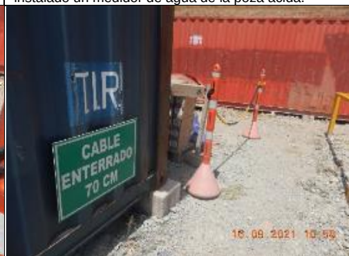
Fotografía N° 153 (DSCN6390.JPG): Vista de la señalética que indica el cableado eléctrico subterráneo para uso en el laboratorio.
