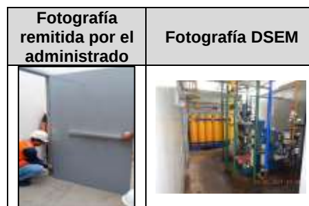
Compresor de GNV
