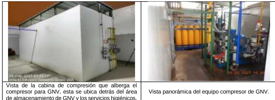
Imagen N° 2. Compresor para el GNV del establecimiento de venta de GNV
