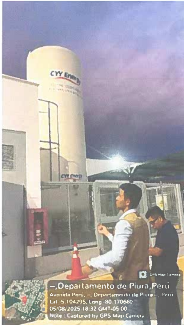
Figura 3. Tanque criogénico del hospital Chulucanas
