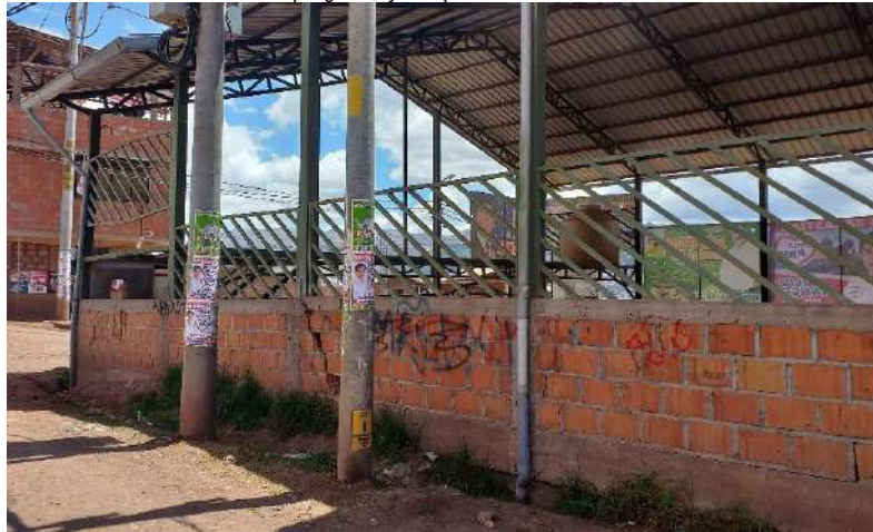
Imagen N° 168: Infraestructura de transformación, y distribución de energía eléctrica en áreas de peligro muy alto por asentamiento
