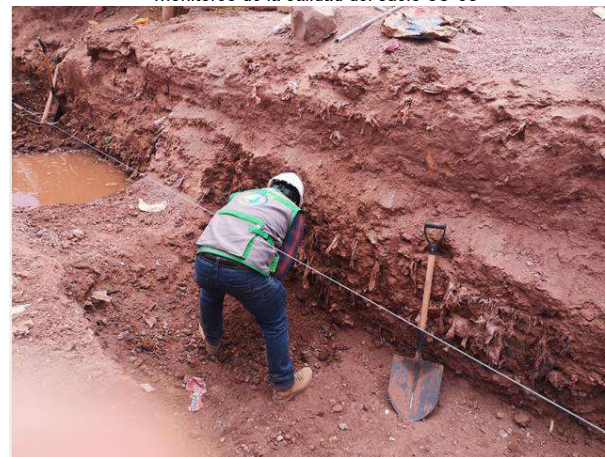
Imagen N° 119: Evidencia de la presencia de residuos sólidos en el punto de monitoreo de la calidad del suelo CS-03
