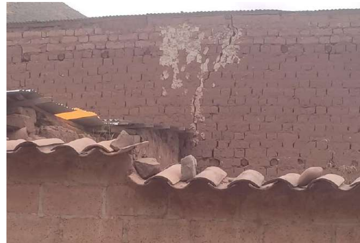
Imagen N° 90: Agrietamientos de las viviendas, construidas sobre material de relleno. Ubicado en la APV. La Fiori
