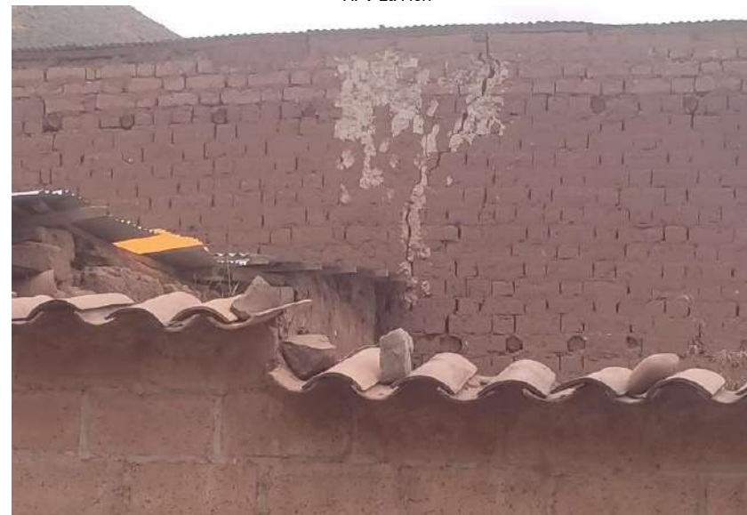
Imagen N° 85: Agrietamientos de las viviendas, construidas sobre material de relleno. Ubicado en la APV La Fiori
