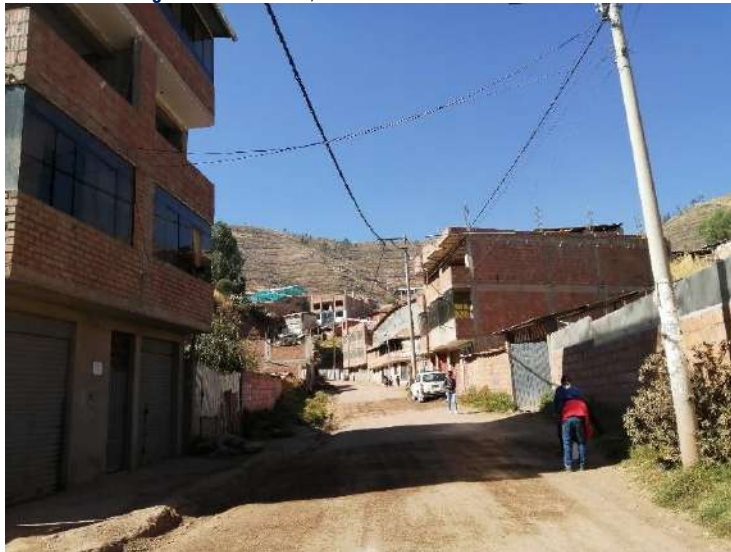
Imagen N° 138: Calle S/N 04 en estado de conservación malo
