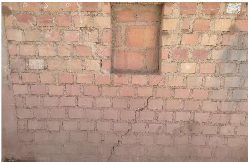
Imagen N° 84: Agrietamientos de las viviendas, construidas sobre material de relleno. Ubicado en la APV Los Frutales
