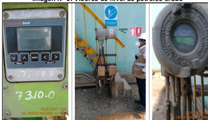
Imagen N° 9: Visores de nivel de petróleo crudo
