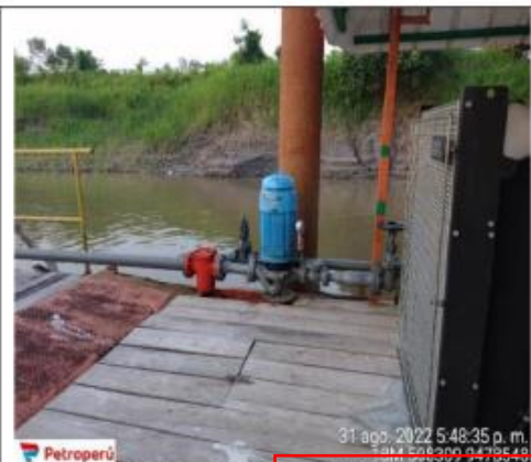
Fotografía N° 4. Área del sistema de Abastecimiento de Diesel antes de la recarga al tanque de combustible. Coordenadas UTM (WGS 84) Zona 18M: N9478548, E508309.
