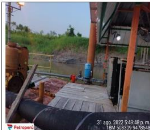
Fotografía N° 3. Área del sistema de Abastecimiento de Diesel antes de la recarga al tanque de combustible. Coordenadas UTM (WGS 84) Zona 18M: N9478548, E508309.
