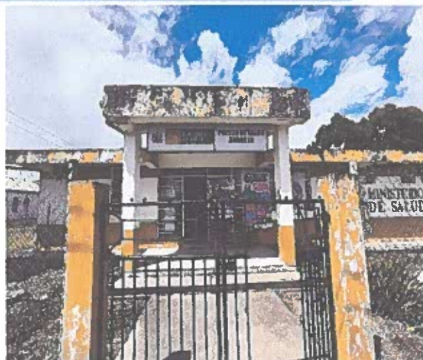
Descripción: Se observa Infraestructura Ineficiente.
