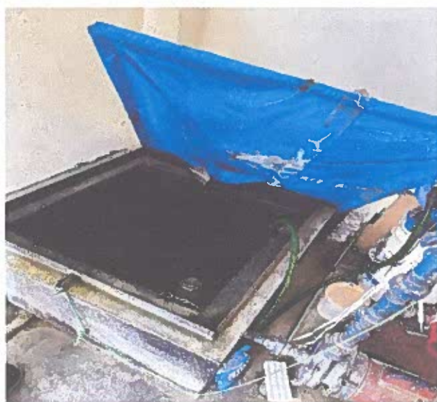
Descripción: bomba de agua que permite su abastecimiento se encuentra inoperativa desde hace más de 10 años
