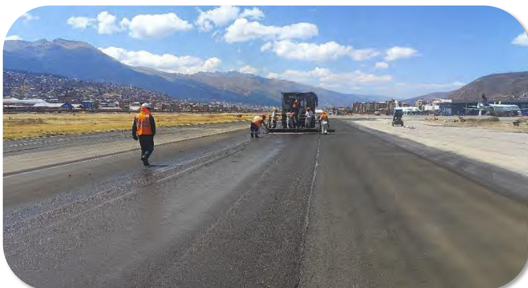
Parchado en la calle de rodaje
