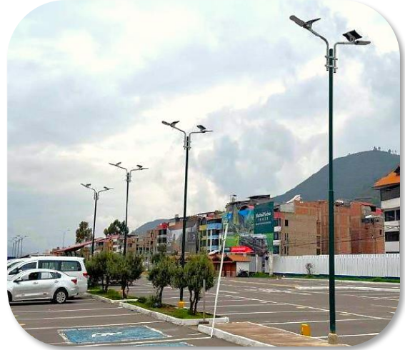
Instalación de iluminación con paneles solares en la playa de estacionamiento vehicular
