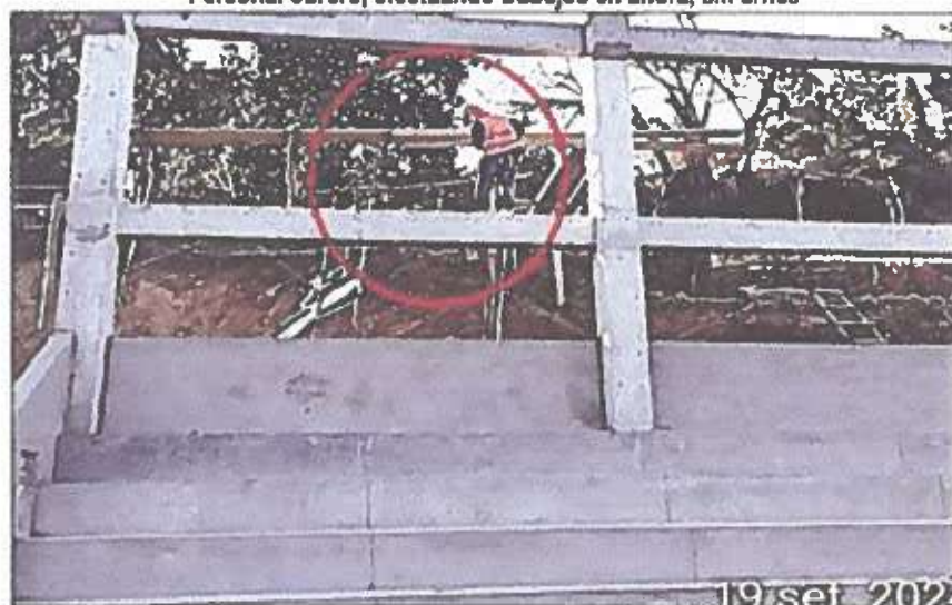
Fotografía n.º 6 Personal obrero, efectuando trabajos en altura, sin arnés
