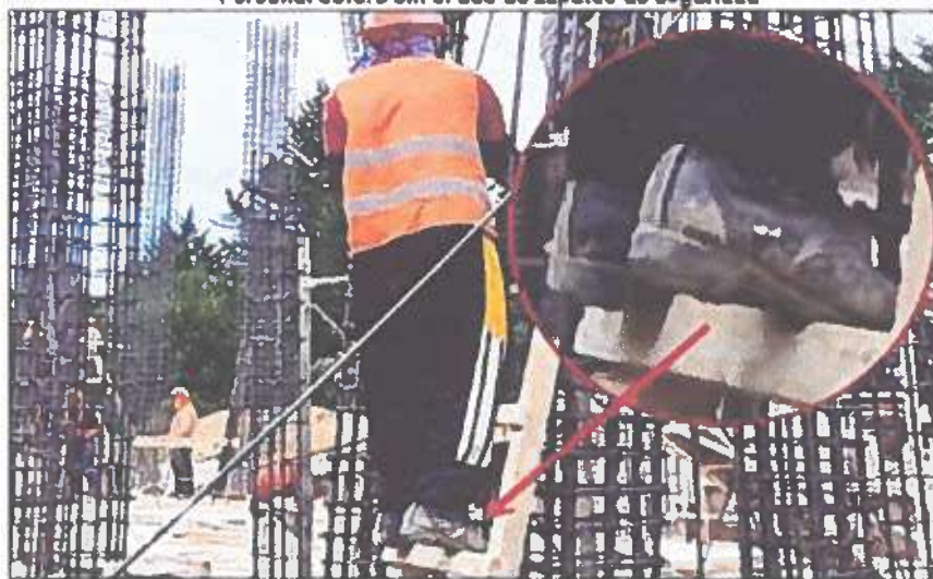
Fotografía n.º 5 Personal obrero sin el uso de zapatos de seguridad
