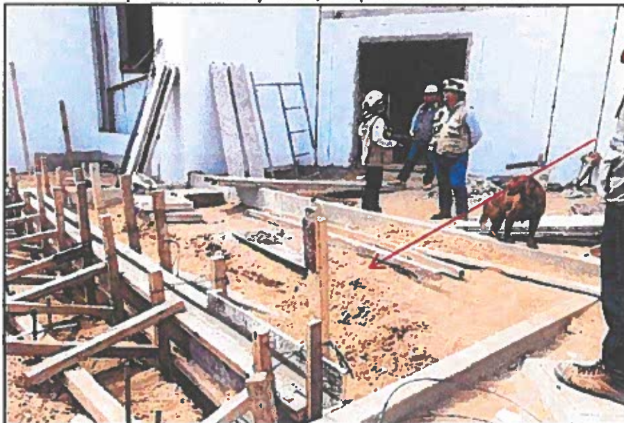
Fotografía n.º 1 Rampa exterior sin ejecutar, se aprecia solo el sardinel.
