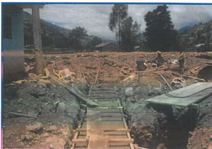
Fotografía N° 02: Desorden del área de trabajo.
