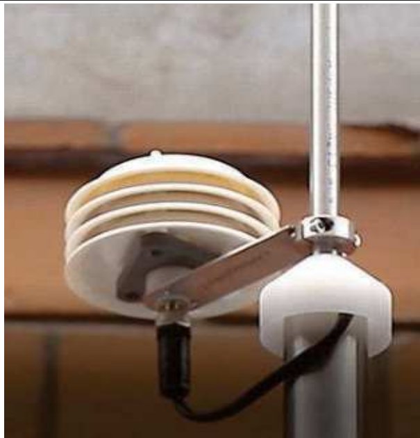
Figura 78. Sensor de Clima instalado en el tubo de muestreo
