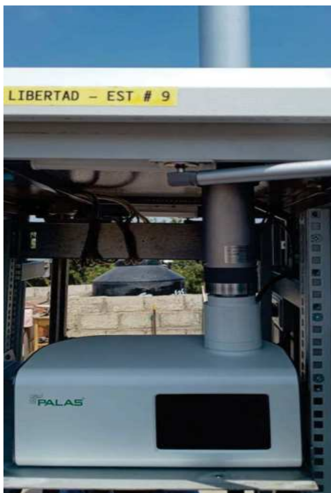
Figura 4. Instalación del Equipo Fidas Smart 100E en la caseta de calidad del aire.
