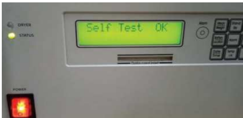
Figura 16. Equipo encendido con secuencia de AutoTest satisfactoria
