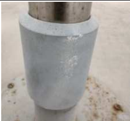
Figura 11. Acople en la parte superior del shelter
