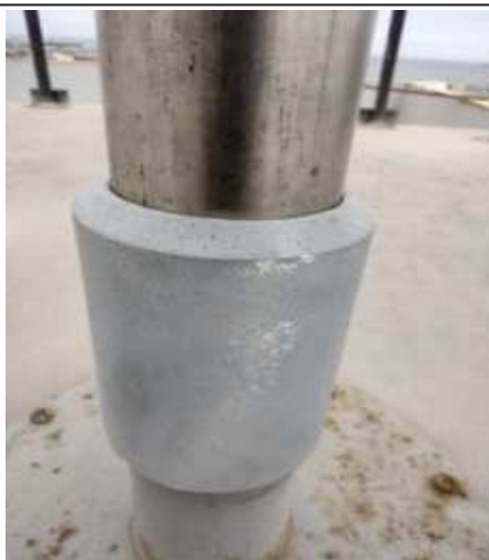
Figura 6. Tubo de muestreo, acople de plástico y conducto de acero fijado al techo.
