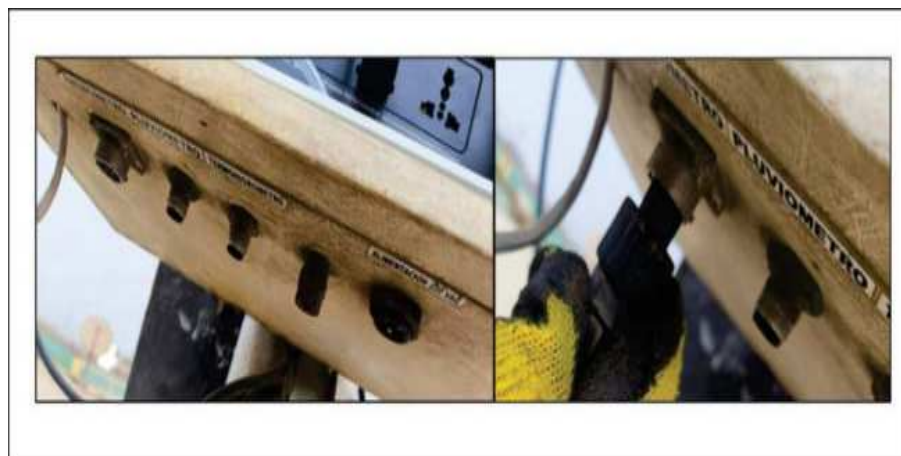
Figura 11. Conexión de sensores al Gabinete
