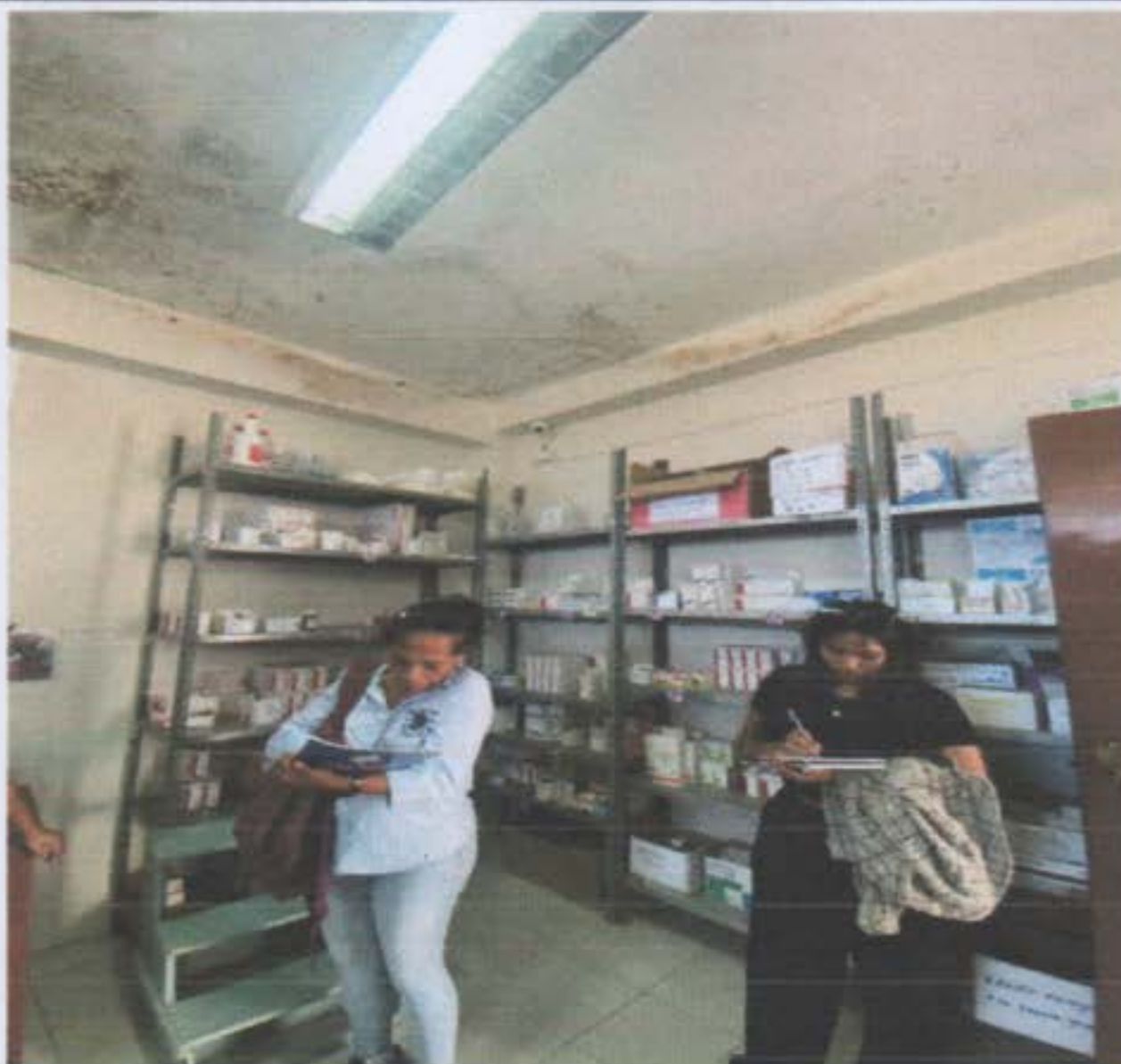
Interiores (Farmacia) del Puesto de Salud Felipe Santiago Salaverry, Pariñas, donde se puede constatar el moho a causa de las filtraciones de agua de lluvia.
