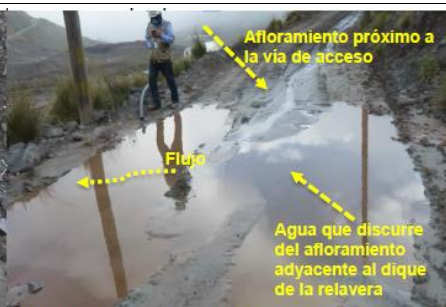
Fotografía N° 168 303 : Las aguas de los afloramientos de las que se encontrarían próxima a la vía de acceso y del afloramiento adyacente al dique del depósito de relaves Chinchán se estarían juntando.
