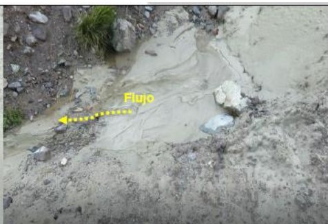
Fotografía N° 166 301 : Otra vista del afloramiento que discurre del afloramiento adyacente al dique del depósito de relaves Chinchán, se observa material de relave que conforma al dique que estaría siendo arrastrado.
