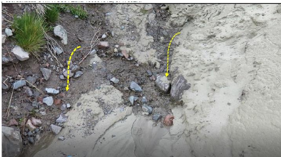
Fotografía N° 164 299 : Otra vista del agua que discurre del afloramiento adyacente al dique del depósito de relaves Chinchán, en las coordenadas UTM WGS84 Zona 18365181E; 8717392N, se observa que el agua estaría aflorando por el talud del acceso y esta tendría contacto con el material del dique de la relavera.
