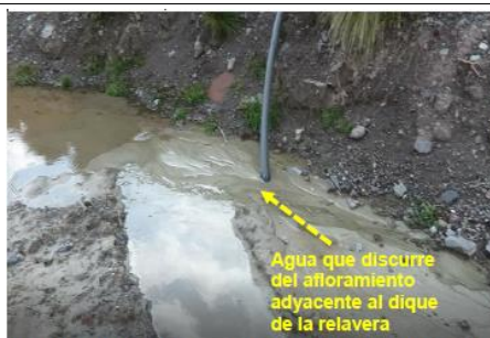
Fotografía N° 167 302 : Otra del agua que discurre del afloramiento adyacente al dique del depósito de relaves Chinchán, se observa material que sería relave que conforma al dique que estaría siendo arrastrado.
