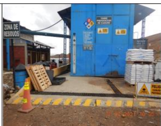
Fotografía N° 06: Vista de torre de precipitación de cianuro, la cual se encontraba sobre una losa de concreto armado, techo metálico y con un letrero de identificación (Ver archivo: DSCN7731).
