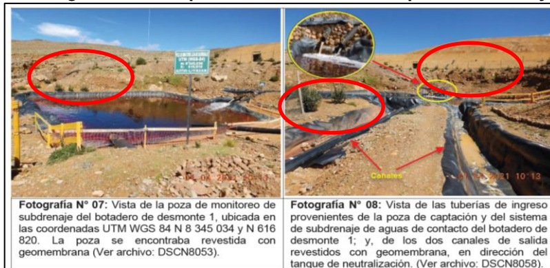
Imagen n.º 7: Fotografías de las pozas afectando los componentes flora y suelo
