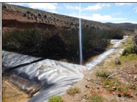
Fotografía N° 12: Vista del humedal aerobio, que presentaba una tubería de ingreso proveniente de la caja de ingreso (poza revestida con geomembrana) y contaba con cuatro humedales con presencia de totoras (Ver archivo: DSCN7959).
