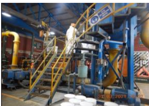
Fotografía N° 03: Vista interior de la planta merrill crowe, donde se encontraron instalados: i) filtros clarificadores; ii) torre de vacío; iii) bomba de vacío; iv) bomba centrífuga; v) tres (3) filtros de prensa y, vi) tableros eléctricos. (Ver archivo: DSCN8881).
