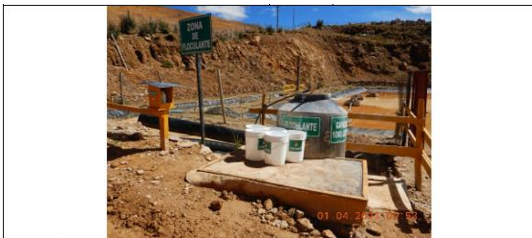
Fotografía N° 17: Vista del tanque de reactivos en la poza de sedimentación N° 1 de la planta de tratamiento 1 - Wetland, el cual se encontraba ubicado en la parte externa y adyacente al canal de ingreso de la poza de sedimentación N° 1 del referido sistema, en las coordenadas UTM WGS 84 N 8 345 033 y E 616 884. (Ver archivo: DSCN8020).
