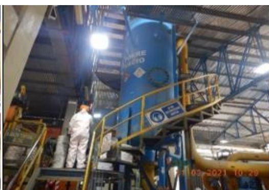
Fotografía N° 04: Vista de la torre de vacío ubicada en el interior de la planta merrill crowe (Ver archivo: DSCN7702).
