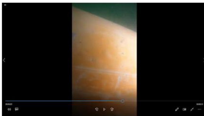
Imagen1: Se puede apreciar las rayaduras al recubrimiento, producto del rozamiento con superficie rocosa del lecho marino
