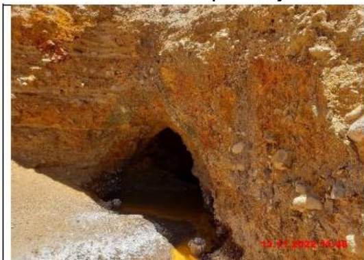
Fotografía N° 22 (20221111_114809). -. Bocamina 8746, se encuentra abierta con presencia de drenaje de mina; no se evidencia la actividad de impermeabilización ni construcción de tapón tipo I ni cuenta relleno exterior conforme estable el MPCPAM San Antonio de Esquilache.
