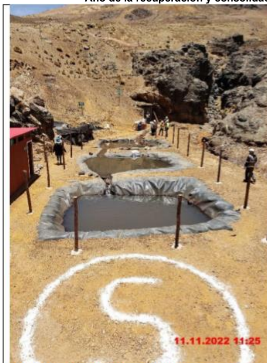
Fotografía N° 12 (20221111_112553).- Vista del sistema de tratamiento del drenaje de mina 8740, el cual lo conforma tres pozas en donde se realiza un proceso de sedimentación, con una breve retención de fluido para regulación de los parámetros de pH. El proceso de regulación de valores de pH, se lo realiza con la adición de solución de Cal y para el proceso de sedimentación con adición de sustancia floculante.
