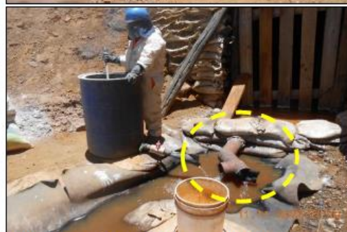
Fotografía N° 13 (DSCN0103, DSCN0086). - Vista del sistema de tratamiento de los drenajes de la bocamina 8740, en la cual se observa la adición de solución de cal (fotografía inferior), así como floculante (fotografía superior). Además, la fotografía inferior se observa que la tubería que descarga el drenaje al sistema de tratamiento cuenta con doble salida— remarcado por un círculo amarillo—.
