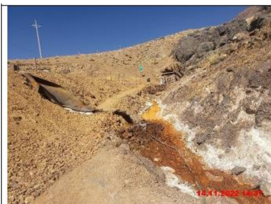
Fotografía N° 18 (20221114_143746). - Otra vista de la quebrada Mercedes, aguas abajo de la bocamina 8740, la cual mantiene sedimentos acumulado en su cauce, los cuales fueron advertidos en el año 2021.
