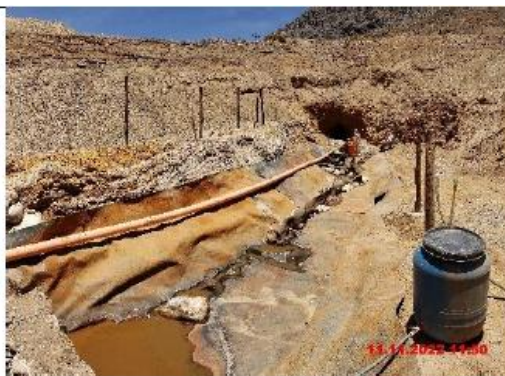
Fotografía N° 25 (20221111_115020). - Vista de la tubería utilizada en la conducción de drenaje de mina hacia la quebrada Caballume.
