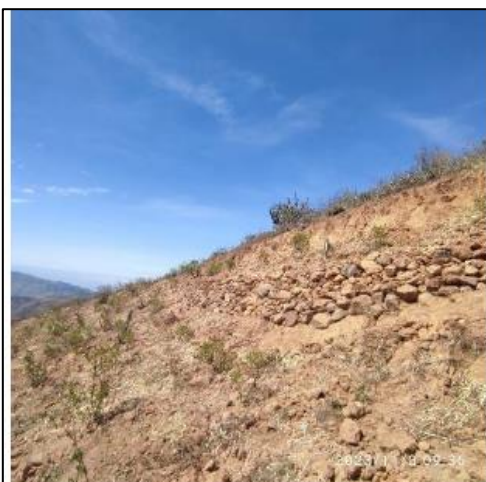
Foto 1. Vista del pequeño talud, antes de las actividades de revegetación.
