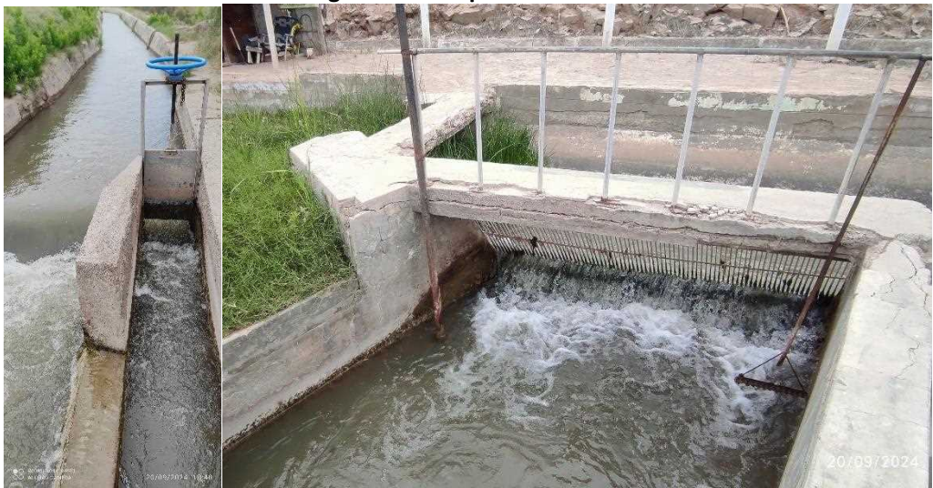
Imagen N° 15: Captación Ite Norte
