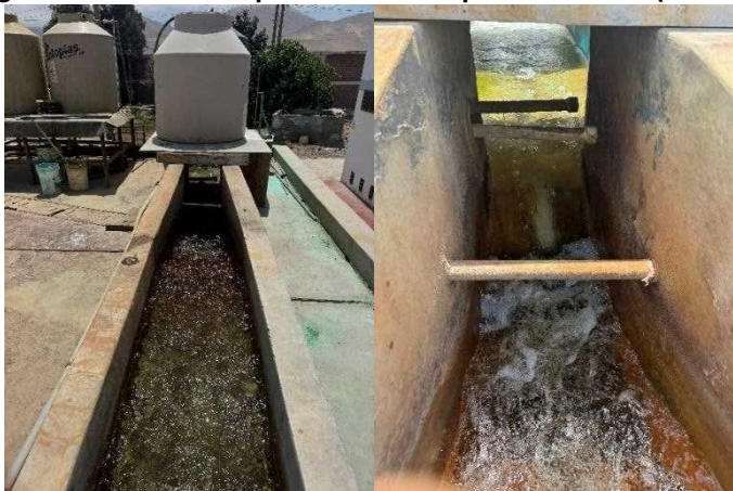
Imagen N° 33: Mezcla rápida - PTAP Pampa Inalámbrica (Módulo A)
