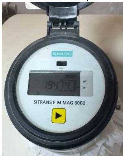
Imagen N° 9: Macromedidor – Captación Pasto Grande
