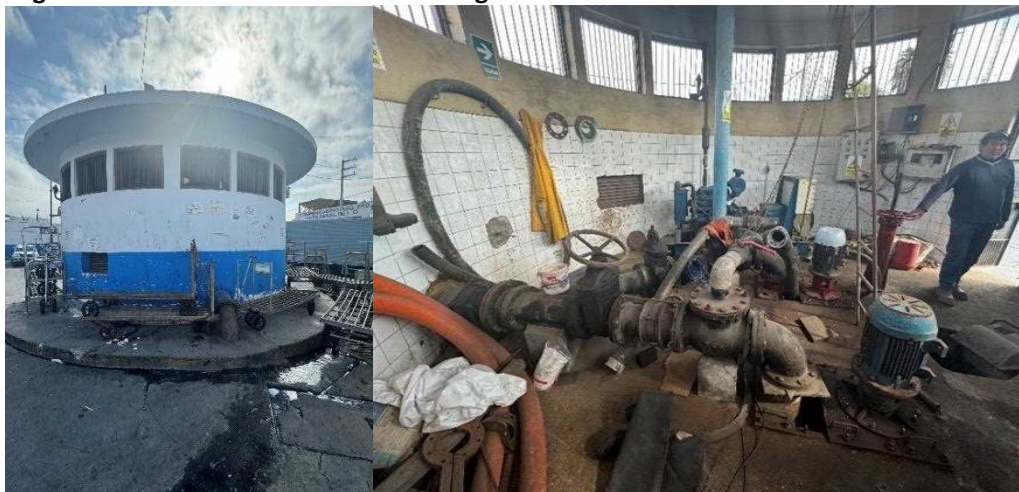
Imagen N° 61: Estaciones de bombeo de aguas residuales N° 1 - Desembarcadero Artesanal
