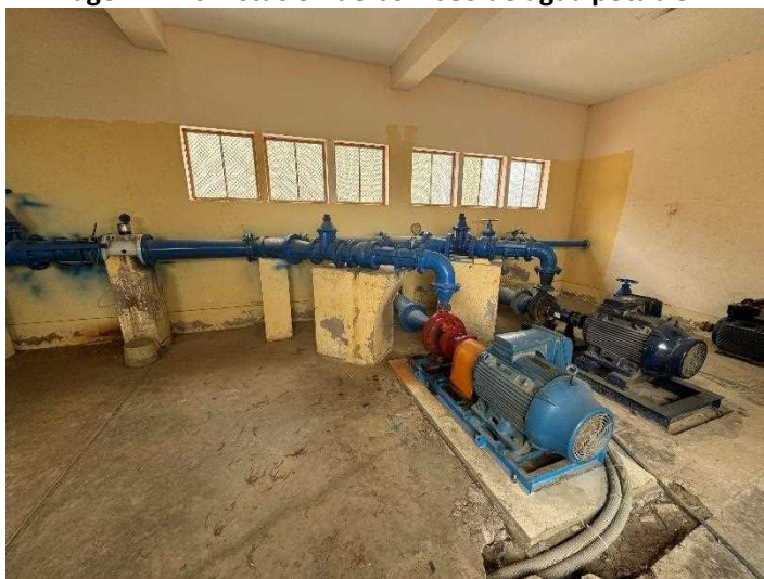
Imagen N° 46: Estación de bombeo de agua potable R-1
