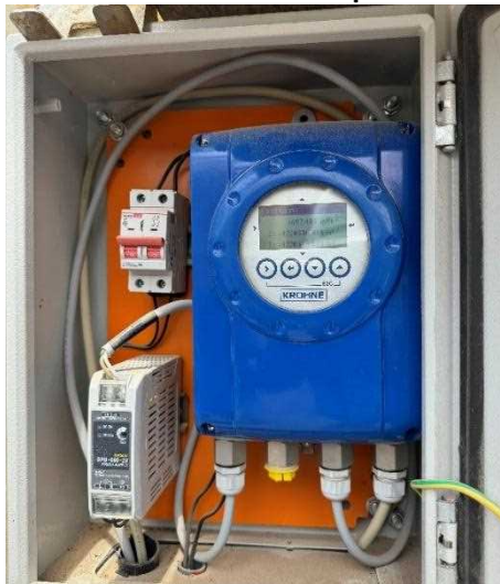
Imagen N° 31: Macromedidor - PTAP Pampa Inalámbrica (Módulo A)
