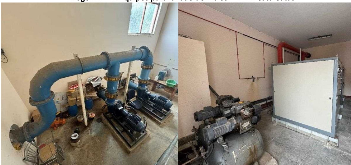
Imagen N° 24: Equipos para lavado de filtros – PTAP Cata Catas
