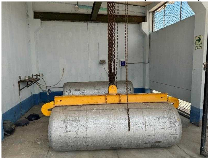
Imagen N° 37: Sistema de cloración - PTAP Pampa Inalámbrica (Módulo A)
