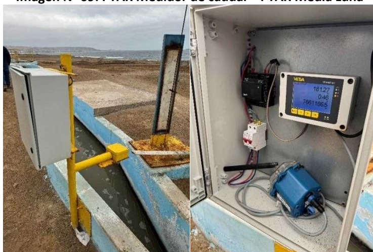
Imagen N° 69: PTAR Medidor de caudal – PTAR Media Luna
