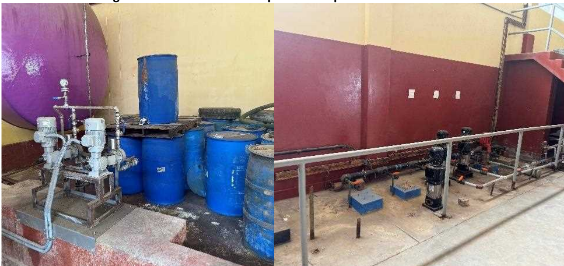
Imagen N° 25: Dosificación de productos químicos – PTAP Cata Catas
