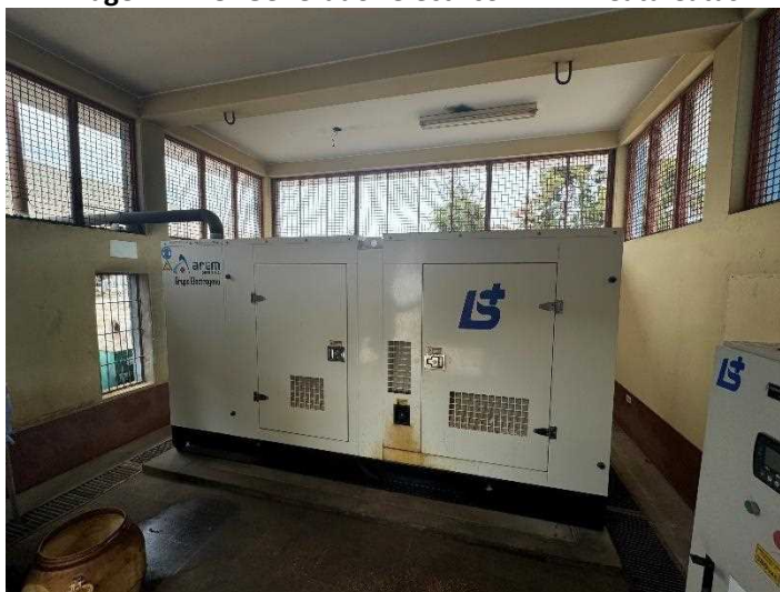
Imagen N° 28: Generador eléctrico – PTAP Cata Catas
