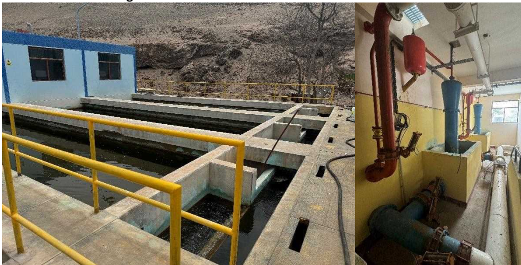
Imagen N° 23: Unidades de filtración – PTAP Cata Catas
