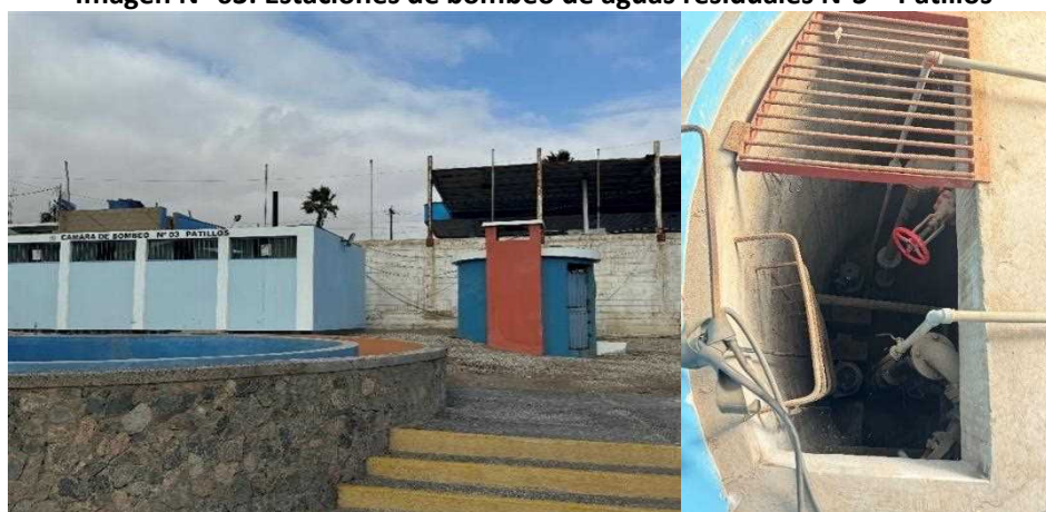
Imagen N° 63: Estaciones de bombeo de aguas residuales N°3 – Patillos
