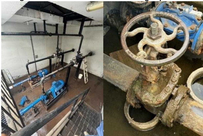
Imagen N° 47: Estación de bombeo de agua potable R-6
