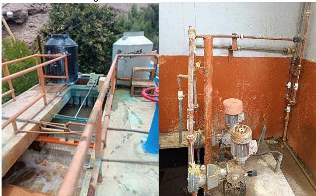
Imagen N° 21: Dosificación - PTAP Cata Catas
