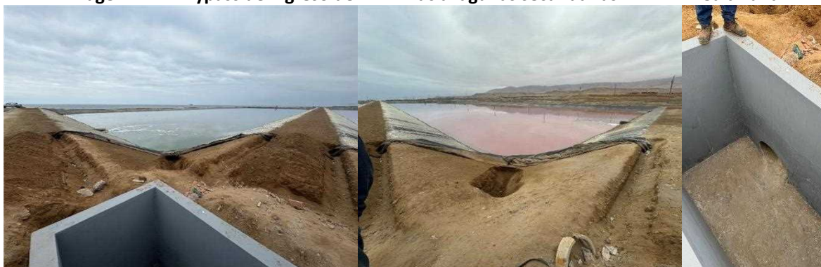
Imagen N° 71: Bypass de ingreso de PTAR hacia lagunas secundarias – PTAR Media Luna
