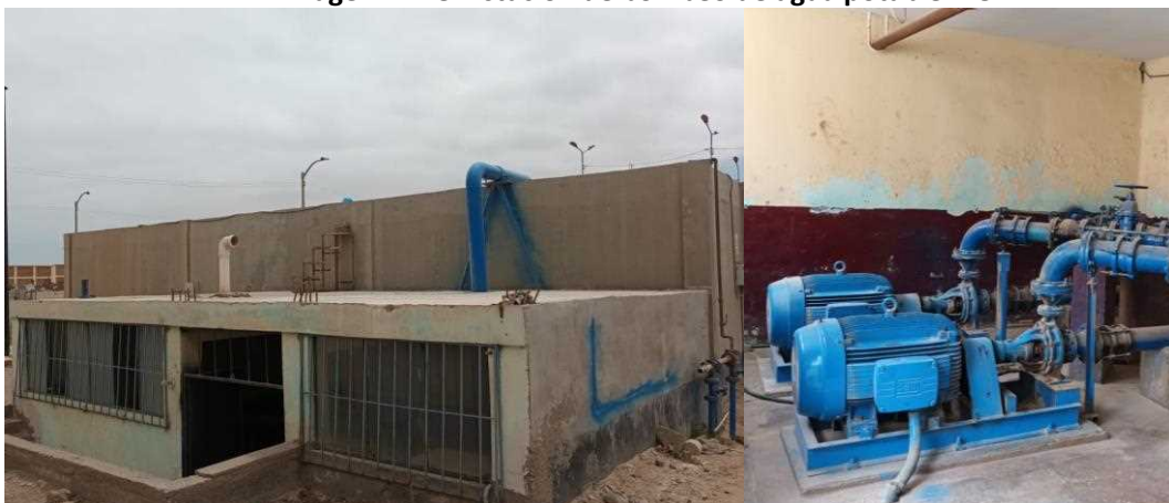
Imagen N° 48: Estación de bombeo de agua potable R-8
