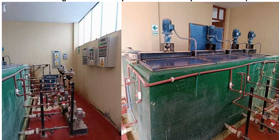
Imagen N° 32: Casa química - PTAP Pampa Inalámbrica (Módulo A)
