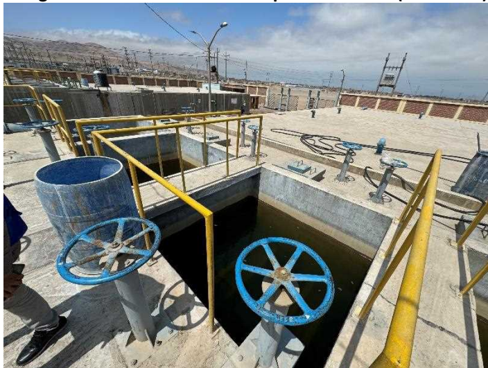
Imagen N° 36: Filtros - PTAP Pampa Inalámbrica (Módulo A)
