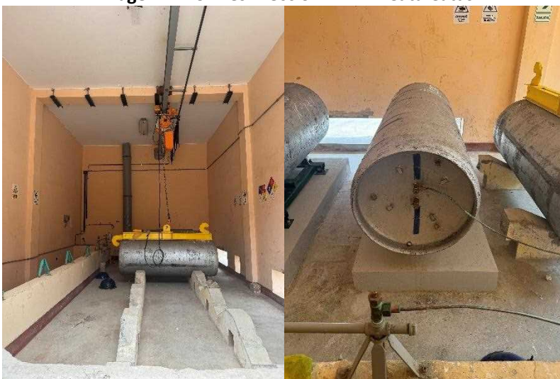
Imagen N° 29: Desinfección – PTAP Cata Catas
