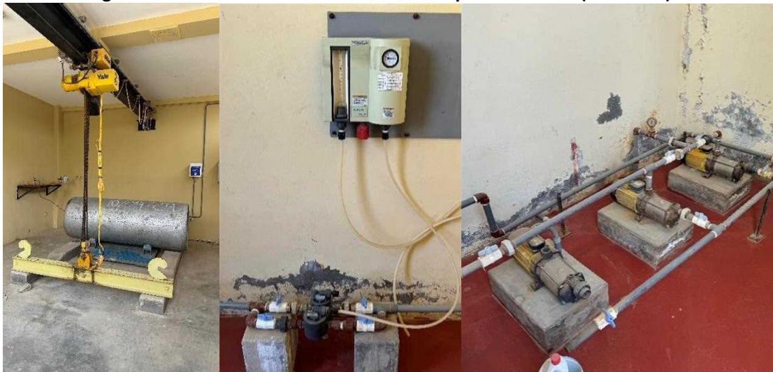
Imagen N° 43: Sistema de cloración - PTAP Pampa Inalámbrica (Módulo B)
