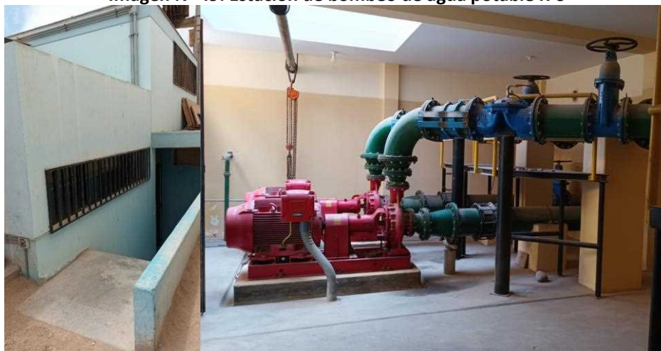
Imagen N° 49: Estación de bombeo de agua potable R-9
