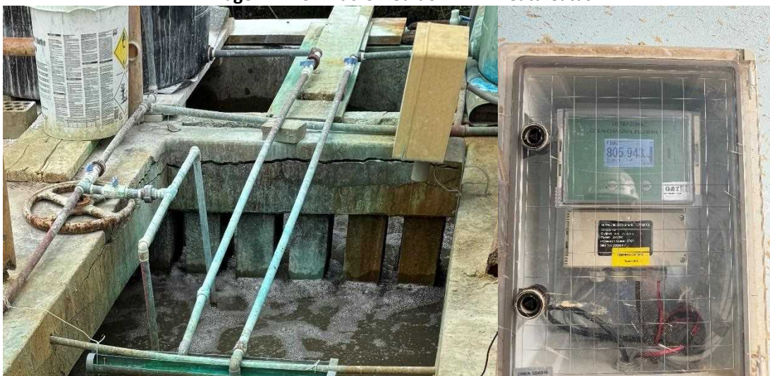
Imagen N° 19: Macromedidor - PTAP Cata Catas
