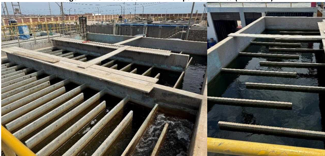
Imagen N° 40: Floculador - PTAP Pampa Inalámbrica (Módulo B)
