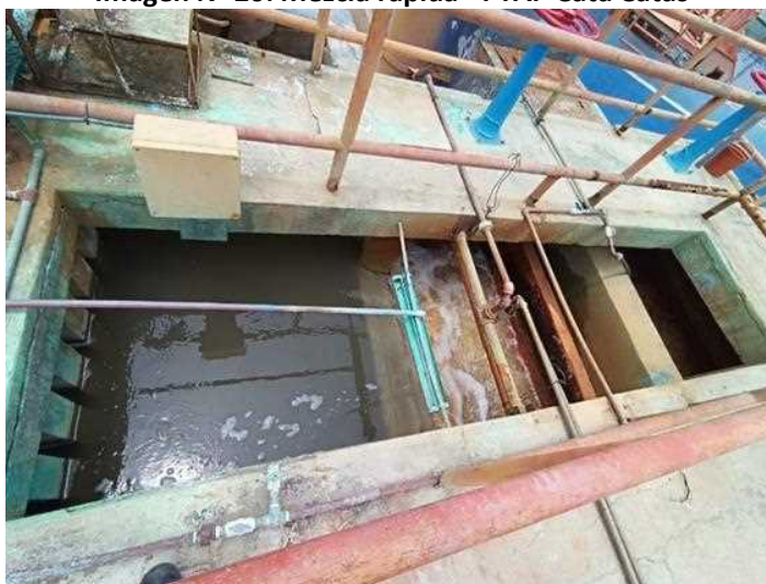
Imagen N° 20: Mezcla rápida - PTAP Cata Catas
