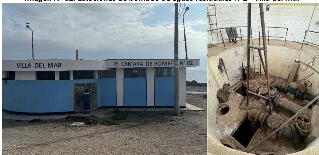
Imagen N° 62: Estaciones de bombeo de aguas residuales N°2 - Villa del Mar
