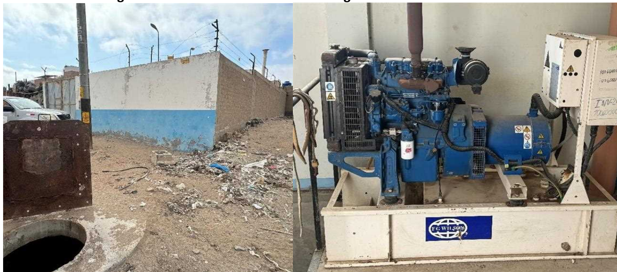
Imagen N° 65: Estaciones de bombeo de aguas residuales N°5 – Nueva Victoria
