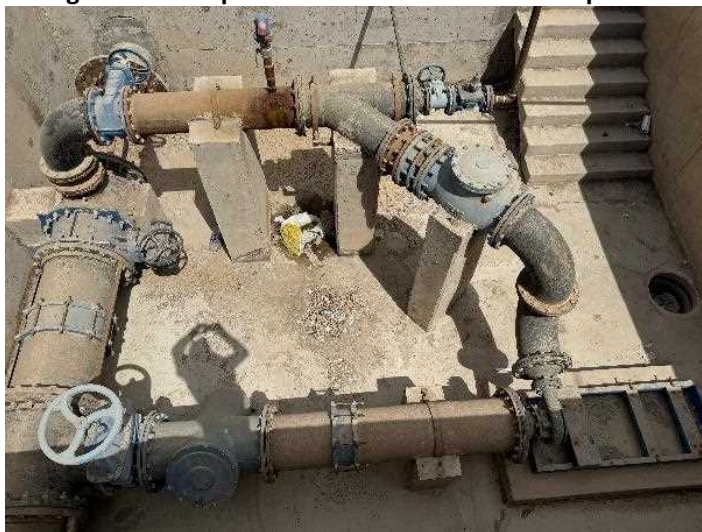
Imagen N° 14: Captación Galerías filtrantes – Inoperativas
