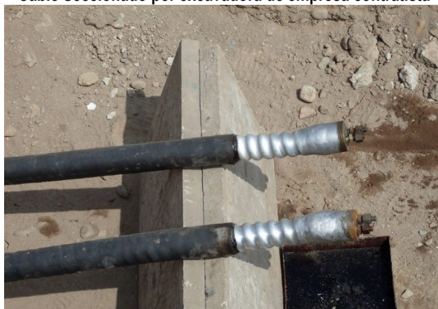
Figura N° 2.5 Cable Seccionado por excavadora de empresa contratista
