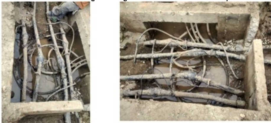
Figura N° 2.4 Las filtraciones de agua han logrado inundar las cámaras de empalme
