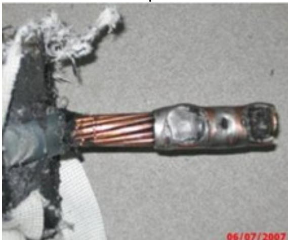
Figura N° 2.3 Conectores inservibles por falla de filtraciones
